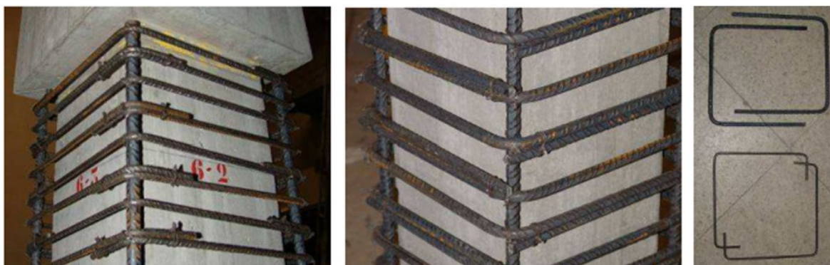
Figura 3 - Exemplo de pilar com aumento de secção de betão armado
