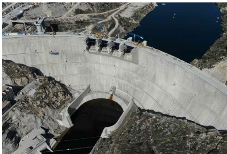
Figura 6 Escalão de Montante: fase final de construção. Abóbada em betão de dupla curvatura, 123m de altura, 32 blocos. Assente em granito. Vista de jusante para montante. (Foto: EDP,2014)
