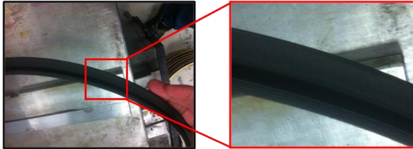
Figura 38 - Núcleo sobressaído em relação á cunha em grande parte do talão
