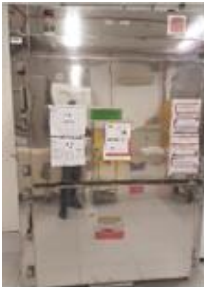
Figura 6 - Frigorífico do Pellet Hopper
