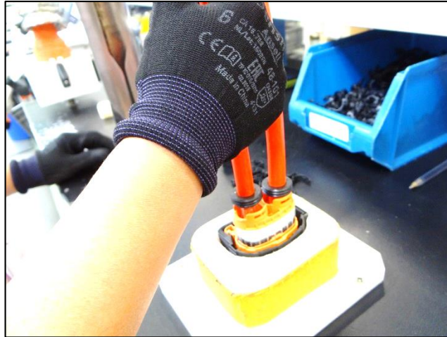
Figura 21 Ligação de cabos de bateria a conetores
