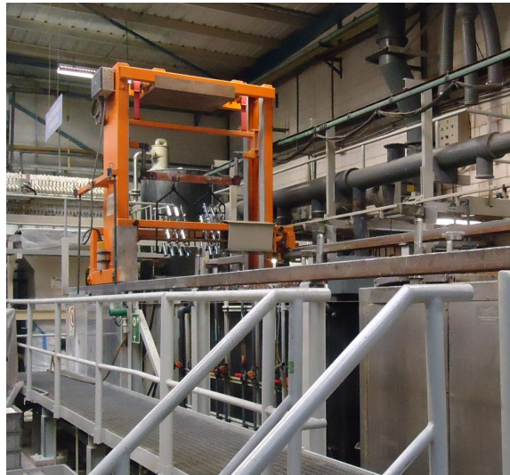
Figura 2.17: Estação de descromagem e desniquelagem.
