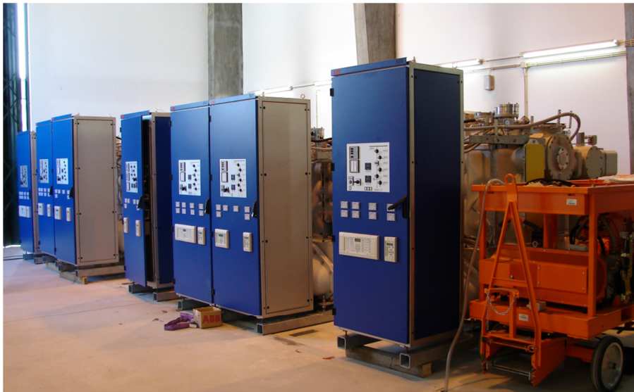
Figura 5 Módulos GIS da Subestação de Energia 60/15 kV de Lamações, Braga, Março de 2013
