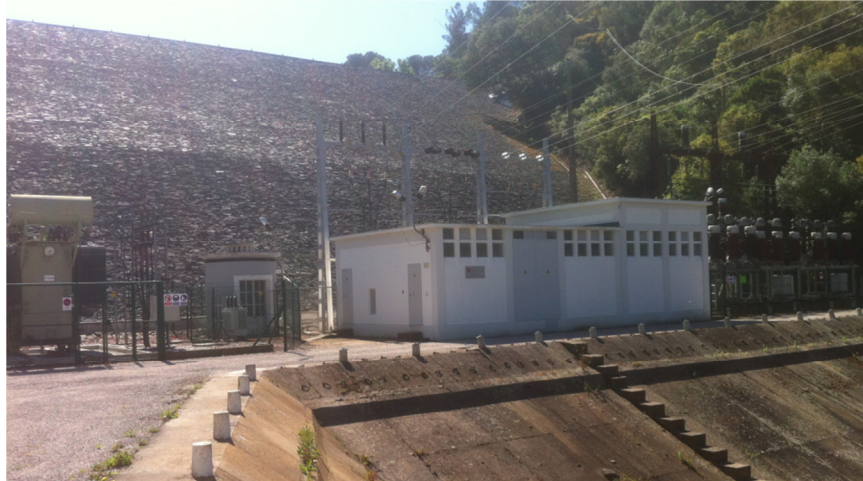
Figura 3 Subestação de Energia 60/30/6 kV de Maranhão, Avis, Julho de 2014
