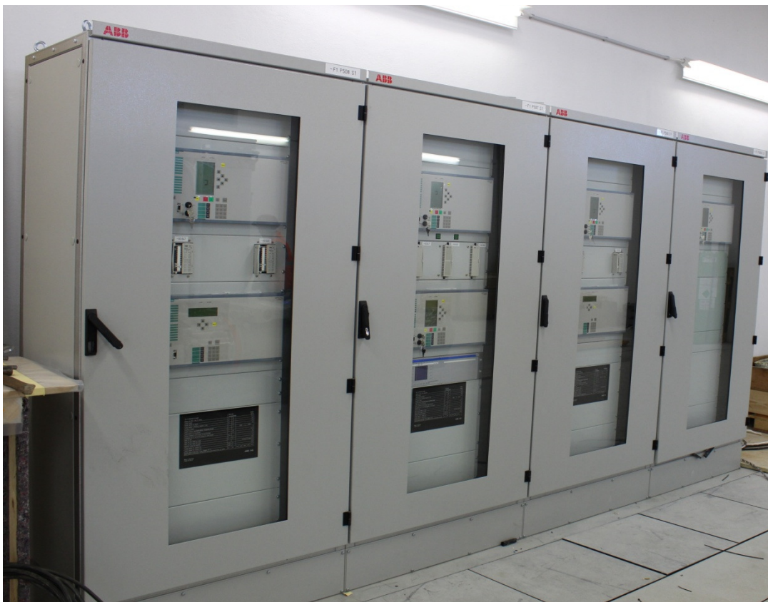
Figura 15 GIS Local Control Cubicle, Leiria, Abril de 2014
