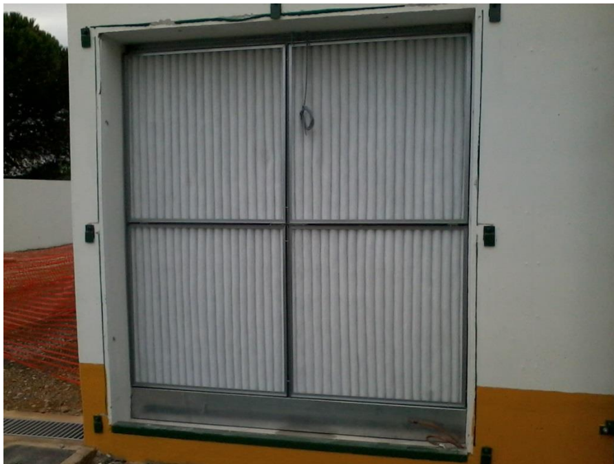
Bateria de filtros lado exterior – admissão de ar
