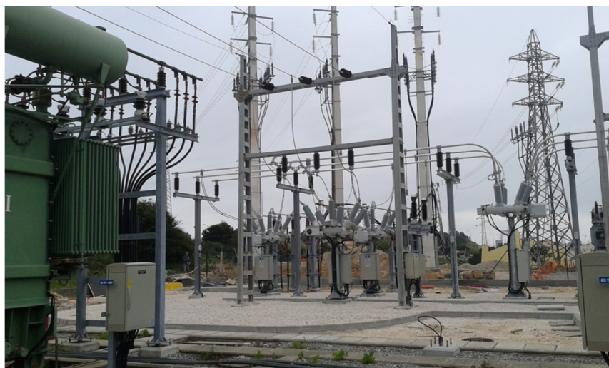
Figura 4 Subestação de Energia de Feitosa 60/15 kV, Ponte de Lima, Junho de 2014
