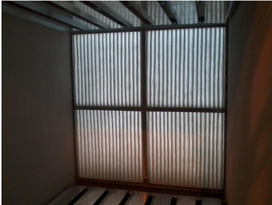
Bateria de filtros lado interior – descarga de ar
