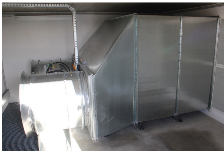
Figura 13 Ventiladores e atenuadores acústicos, Leiria, Abril de 2014
