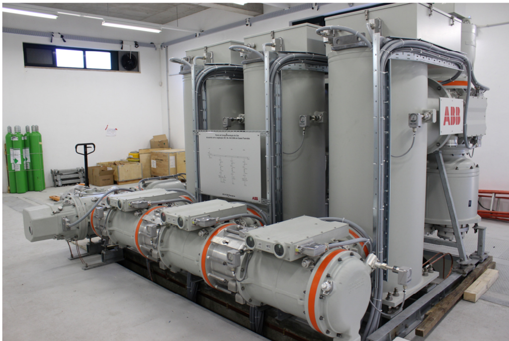
Figura 12 Equipamento GIS de 60 kV da ABB, Leiria, Fevereiro de 2014
