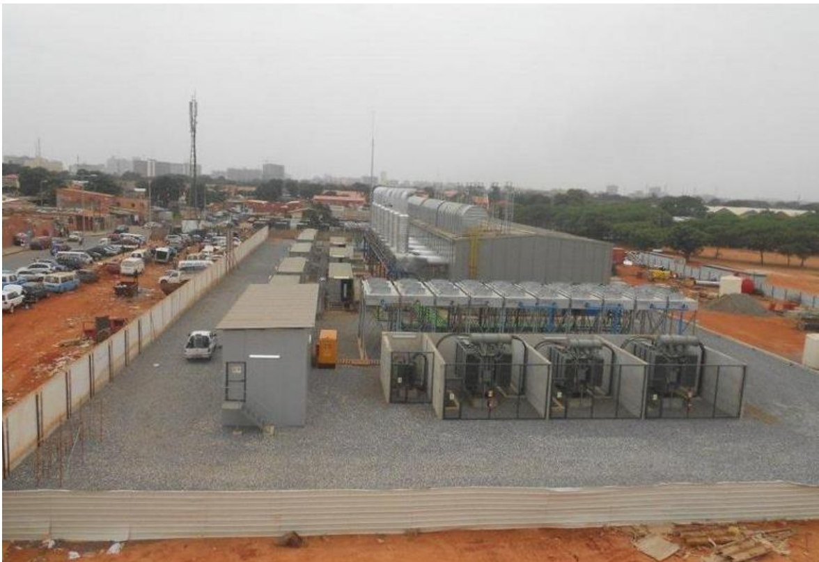
Figura 1.3 – Power House's (Angola) – Foto 1
