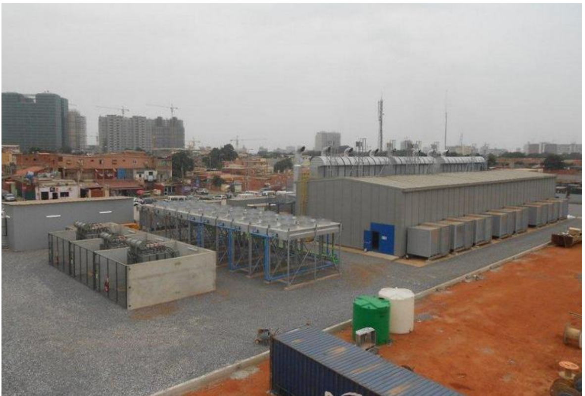
Figura 1.5 – Power House's (Angola) – Foto 3
