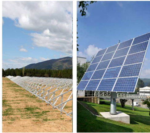
Figura 12 - Estruturas de instalações de painéis solares
