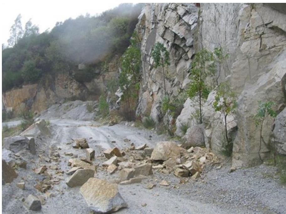
Figura 16 – Talude da pedra de Joane com queda de blocos (adaptado de Mendes, 2018)
