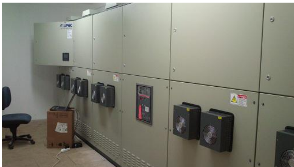
Fig. 6.5 - Parte do sistema de 3,6kVAr.
