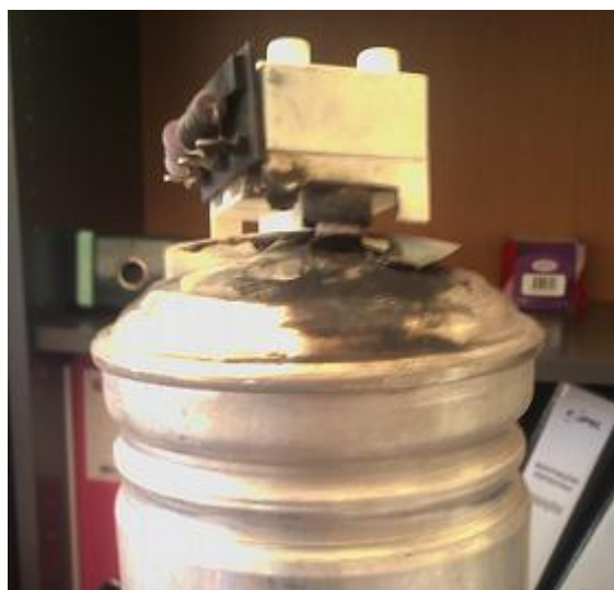
Fig. 4.4 - Aspeto de condensador impregnado a gás após destruição.
