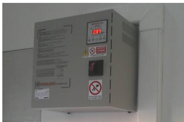
Fig. 4.21 - Bateria de condensadores convencional de 35kVAr.
