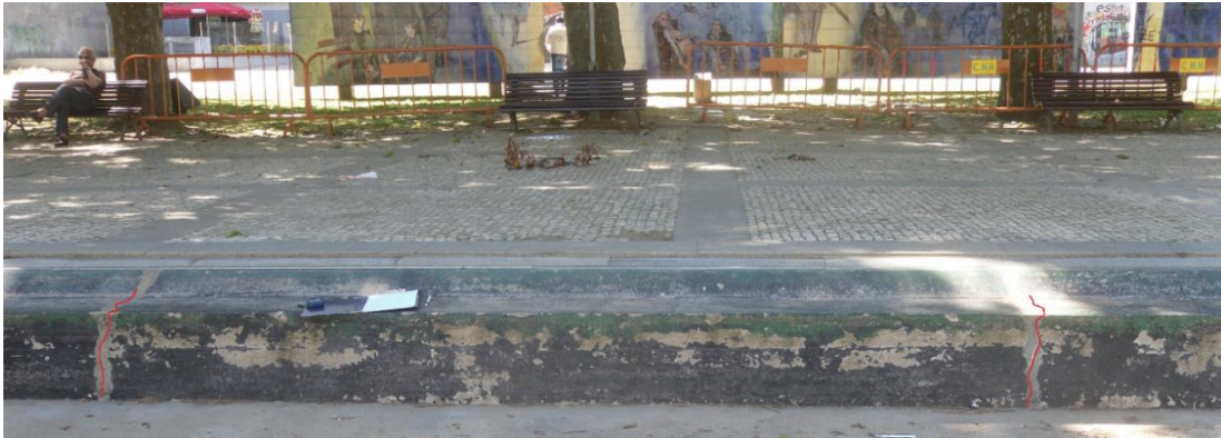
Figura 4 - Murete a Este. Fissuração, desgaste de pintura e betão.
