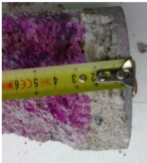
Figura 6.21 - Medição da profundidade de carbonatação na Carote 2 do Pilar G2 após ensaio de compressão.
