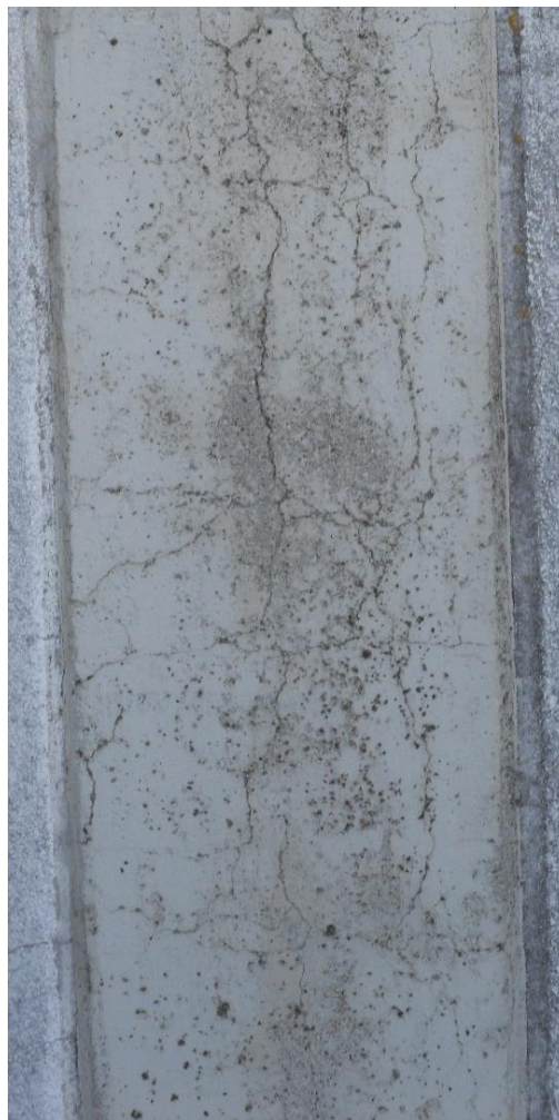
Figura 6.47 – Fissuração no Pilar F2.
