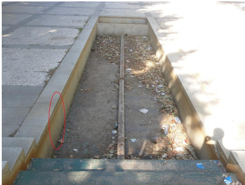
Figura 7 - Juntas de placas de Granito com falta de material.
