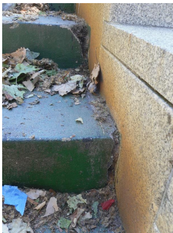
Figura 10 – Escadas, degradação do betão.
