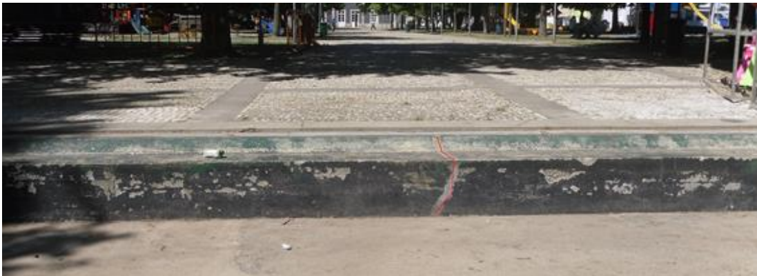
Figura 5 - Murete a Sul. Fissuração, desgaste de pintura e betão.
