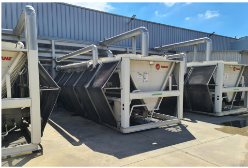
Figura 3.3: Unidades de arrefecimento de água 1, 2 e 3, do tipo Ar - Água [1]
