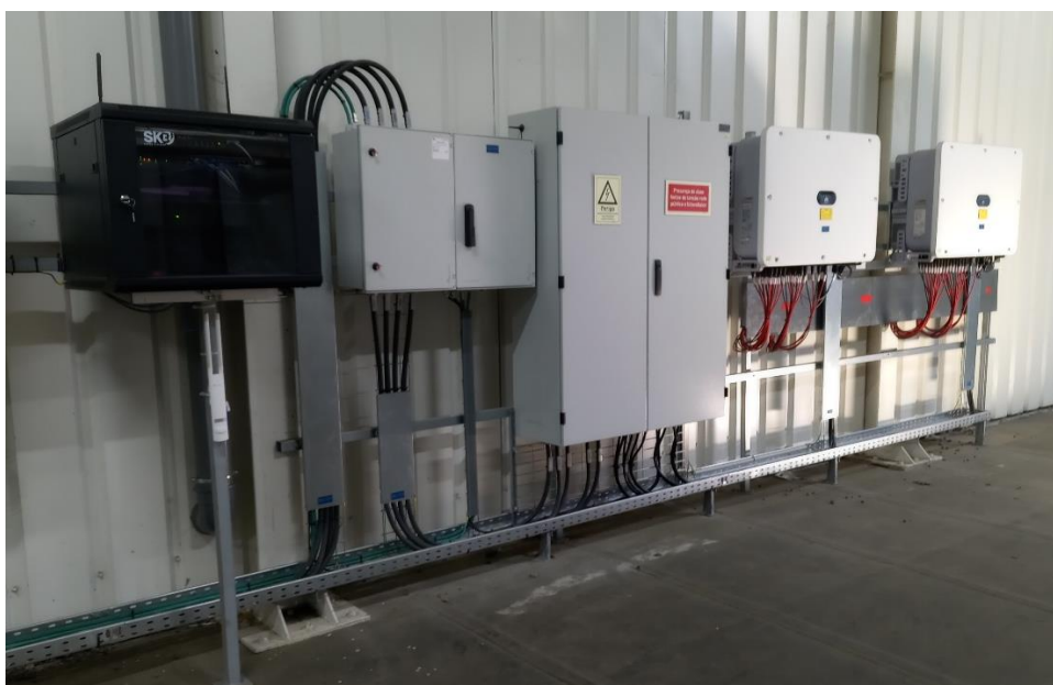
Figura 27 - Zona técnica de uma instalação UPAC.
