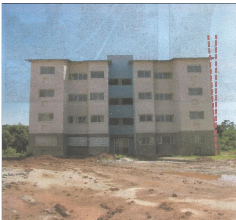
Figura 5.8 – Desaprumo dos edifícios ocasionado pelo recalque das fundações (Fonte: Empresa executora do reforço, 2017).
