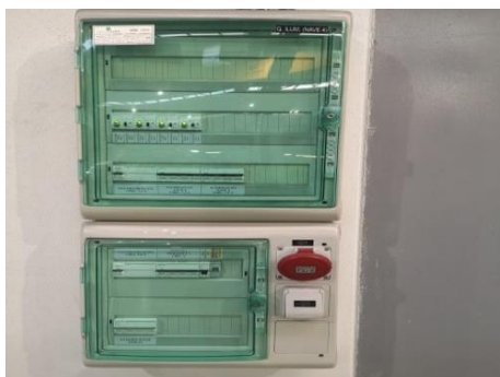
Figura 31 - Quadro elétrico com proteção
