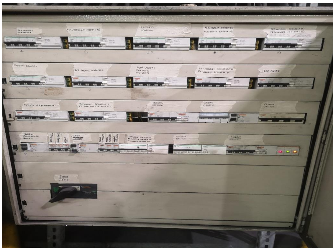
Figura 48 - Quadro elétrico fornecedor provisoriamente identificado
