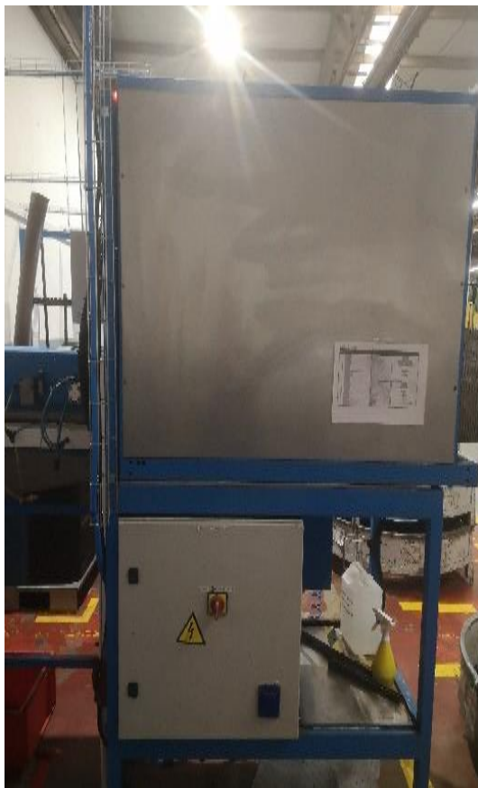
Figura 36 - Quadro individual de máquina
