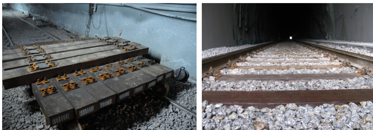
Figura 12: Fixação Vossloh em travessas de madeira azobé (Túnel de Tamel á esquerda, Túnel de Caminha á direita) na Linha do Minho. (Fonte: da autora, 2011)
