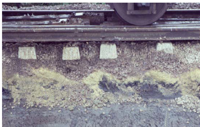
Figura 23: Bolsas de solo plastificado em intrusão com as banquetas de balastro. (Fonte: Powrie e LePen, 2016) Estas bolsas são visíveis, quando começam a formar-se, por protuberâncias longitudinais ao longo das bases das banquetas de balastro que começam a misturar-se com o solo. Depois de formadas evoluem, afetando, para além da camada de coroamento, o núcleo da plataforma, chegando a
