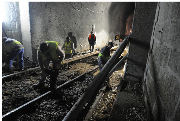
Figura 61: Presença de água na plataforma da via – férrea junto á boca de saída do túnel de Tamel na linha do Minho. (Fonte: da autora, 2011)
