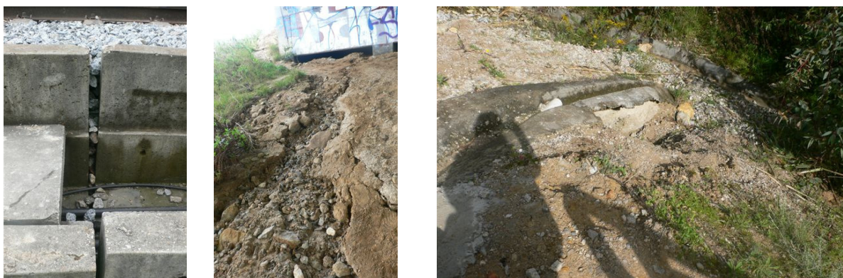
Figura 52: Patologias detetadas na inspeção realizada ao PK 19+350 da Linha de Sintra. (Fonte: da autora, 2008)
