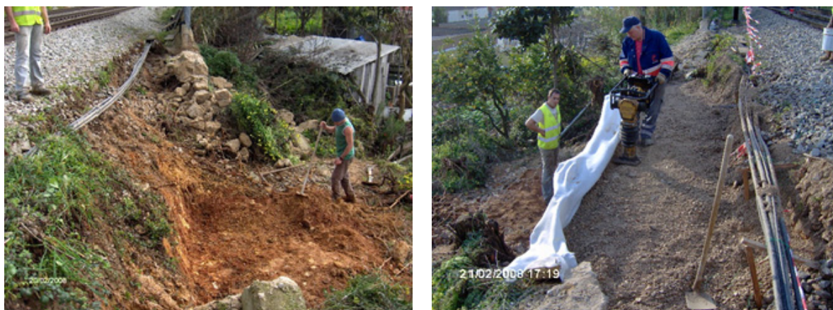
Figura 53: Abatimento da lateral da plataforma ferroviária á esquerda e mitigação provisória realizada, á direita, ao PK 20+270 da Linha de Sintra. (Fonte: da autora, 2008)
