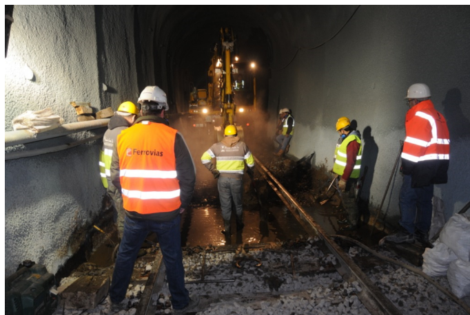
Figura 77: Presença de água constante no rebaixamento da plataforma do Túnel de Tamel – Linha do Minho. (Fonte: da autora, 2011)
