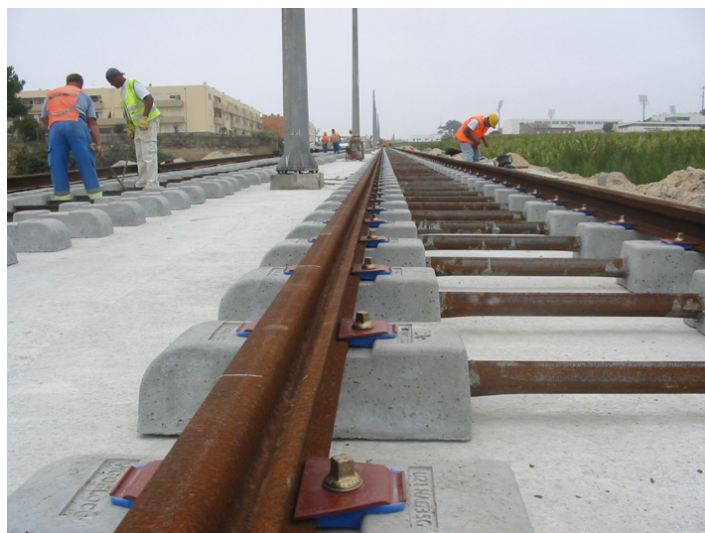
Figura 8: Exemplo de travessas bi-bloco em assentamento de via no Metro do Porto. (Fonte: da autora, 2004)
