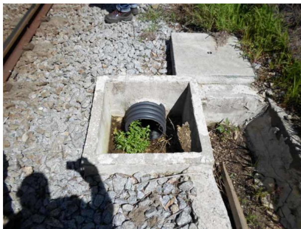
Figura 47: Caixa de visita da drenagem longitudinal da plataforma de via executada junto á boca de entrada do túnel de S. Miguel de Carreira na Linha do Minho. (Fonte: da autora, 2010)
