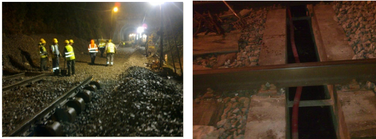
Figura 46: Remoção do balastro, escavação e escarificação da plataforma (esquerda) e pormenor da PH (direita) junto á boca de saída do túnel de Tamel da Linha do Minho. (Fonte: da autora, 2011)
