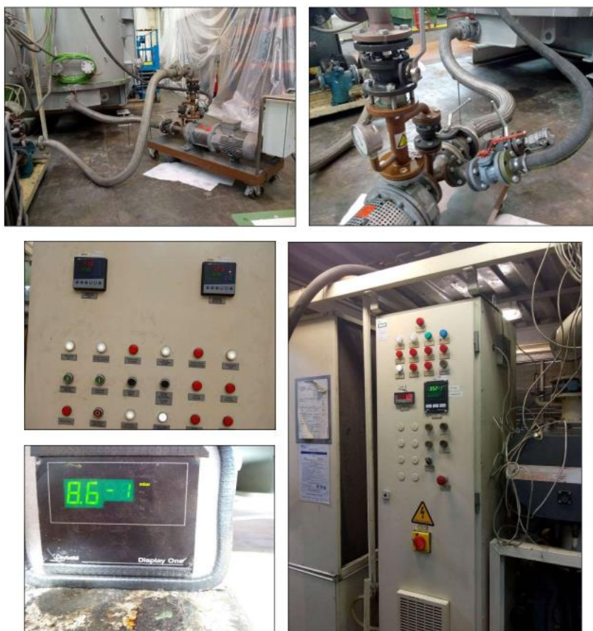
Figura 5.27 - Circuito de vazio e bomba de circulação de óleo
