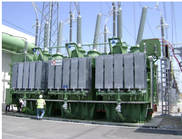
Figura 2.1 - Transformador de potência EFACEC (Subestação da REN de Lagoaça)
