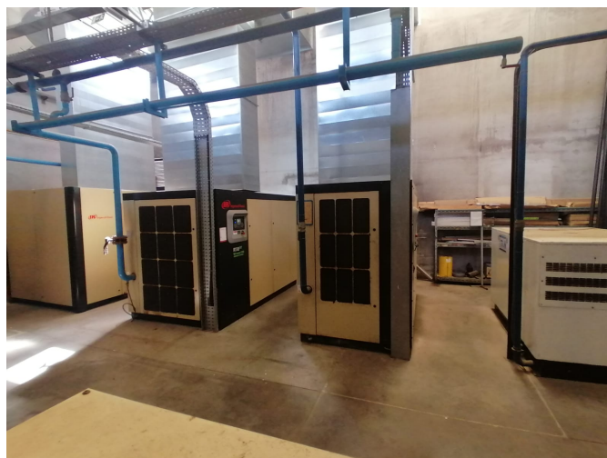
Figura 4.23: Compressores instalados no caso de estudo.
