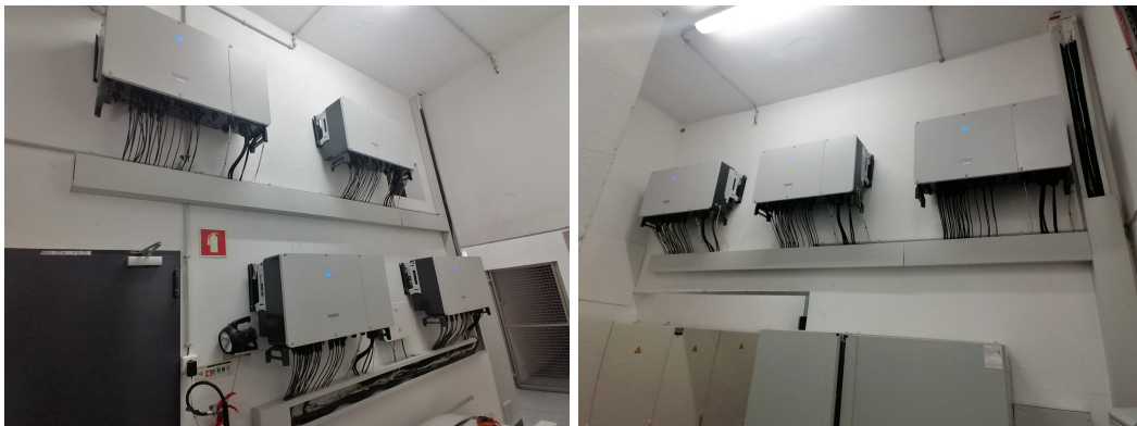
Figura 4.18: Inversores instalados no PT.
