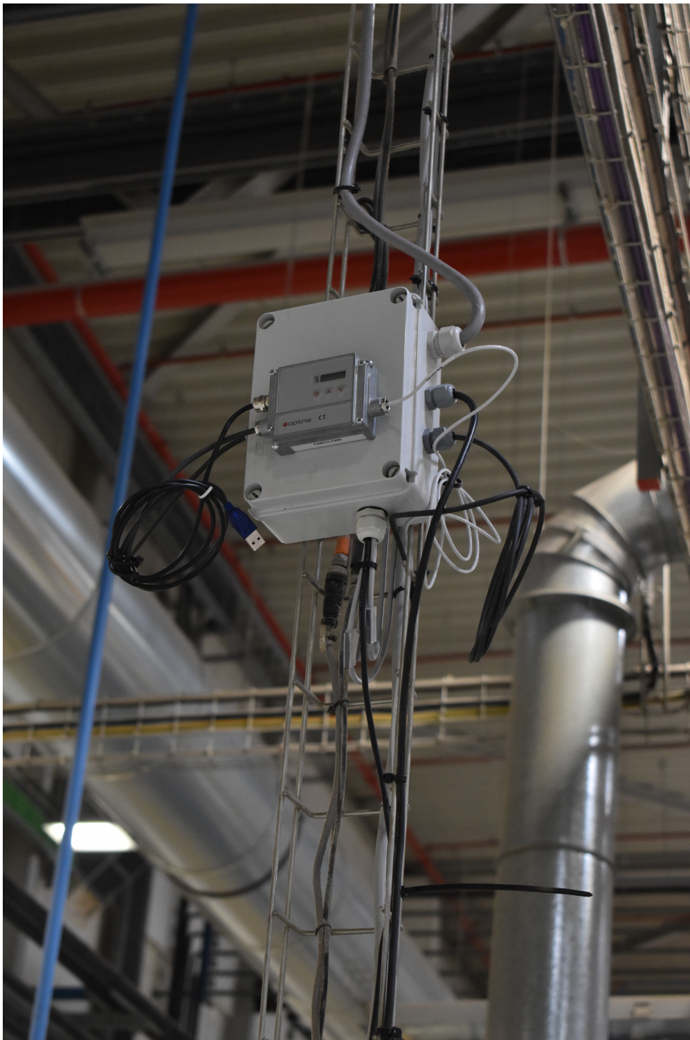
Figura 6.9: Vista geral da caixa de derivação
