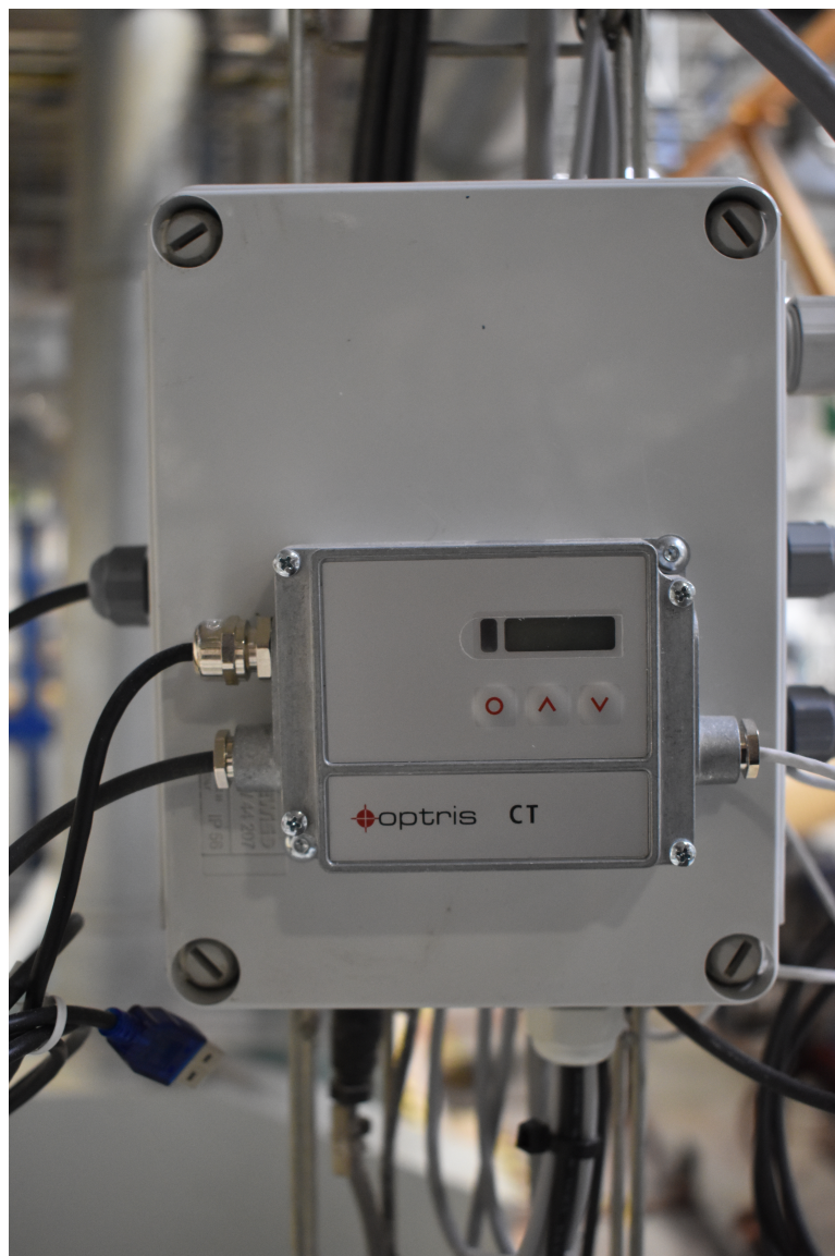
Figura 6.6: Caixa de derivação e controlador do sensor Optris CT
