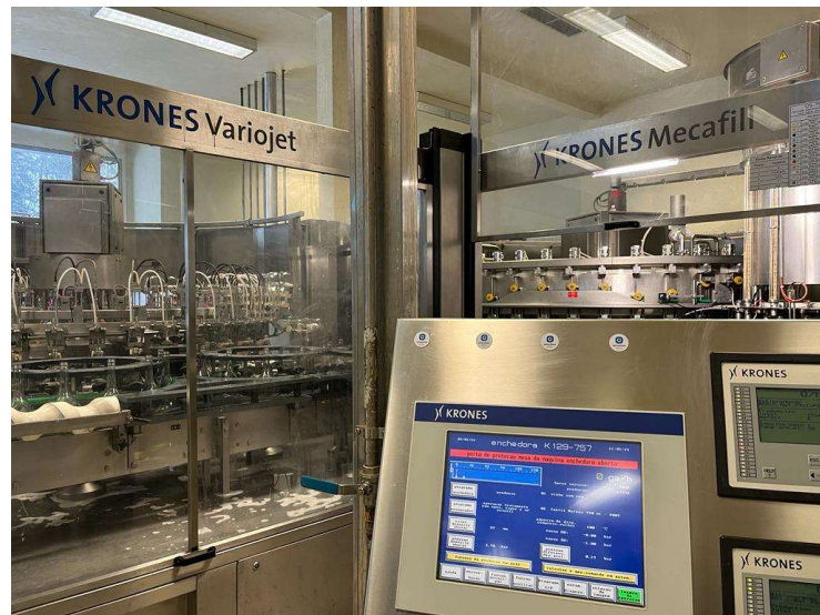
Figura 36 - Fotografia de identificação de 4 equipamentos em bloco com etiqueta NFC.
