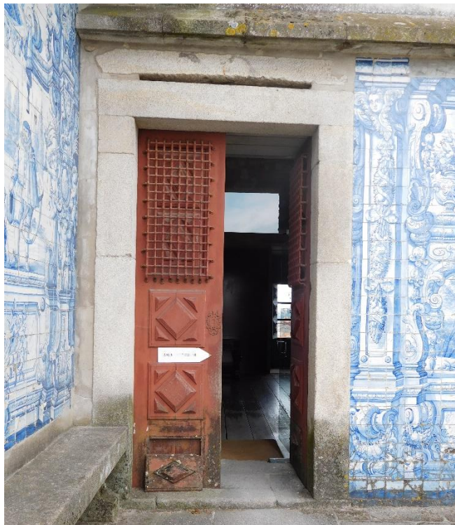
Figura 77: A porta que dá acesso do Claustro Superior à Sala Capitular necessita de intervenção
