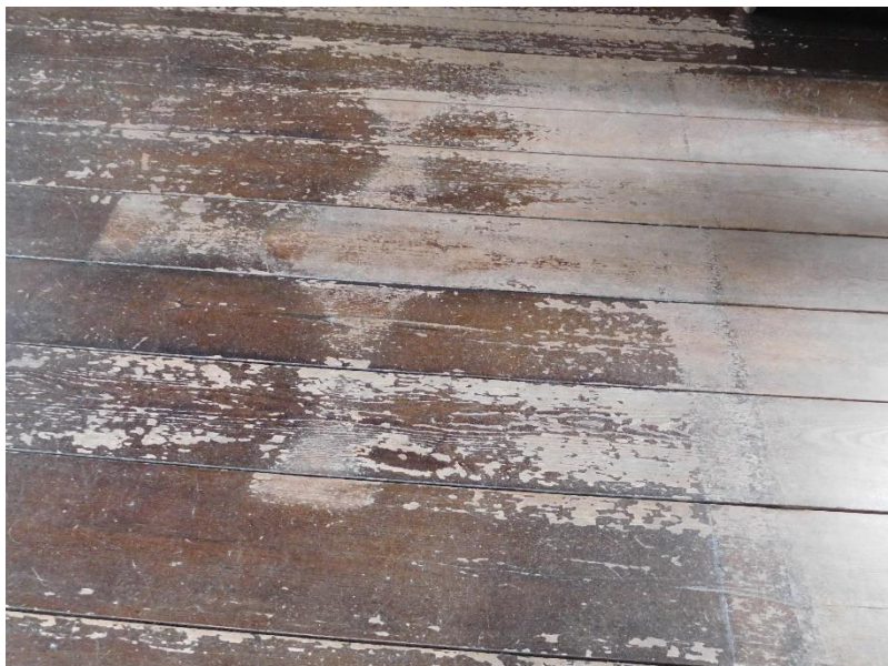
Figura 78: Pavimento danificado na Sala do Capítulo, necessita de intervenção
