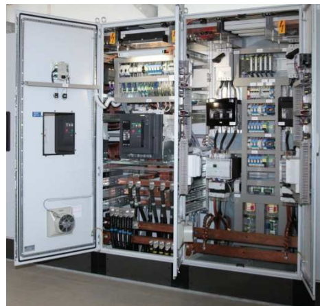
Figura 2.2. Armário de distribuição [16].
