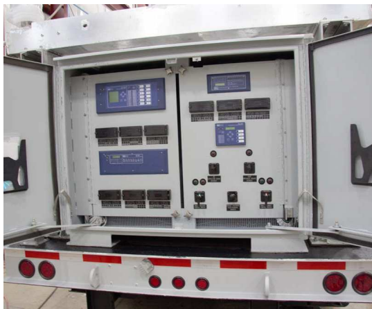
Figura 2.1. Armário de Relés de proteção [15].
