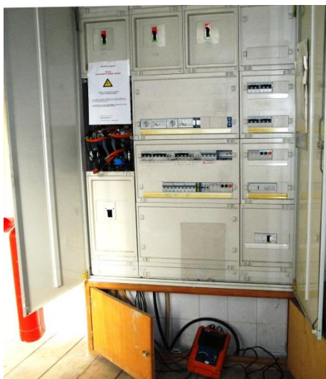
Figura 3.15 - Analisador de Energia ligado ao Quadro Geral.
