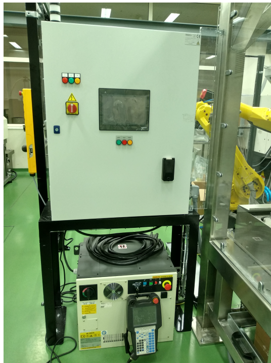
Figura 5.8: Disposição do quadro elétrico e do controlador do robô de extração.
