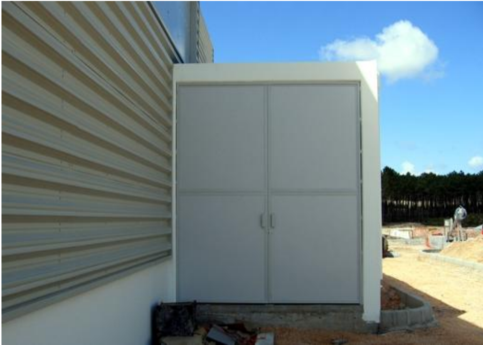
Figura 36 - Porta de posto de transformação com estrutura executada com perfil pultrudido [46]
