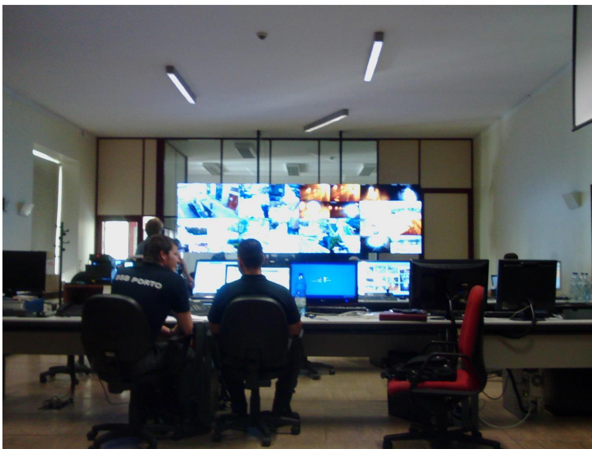
Figura 3.2 – Sala de Controlo de tráfego (26 de Junho de 2015)
