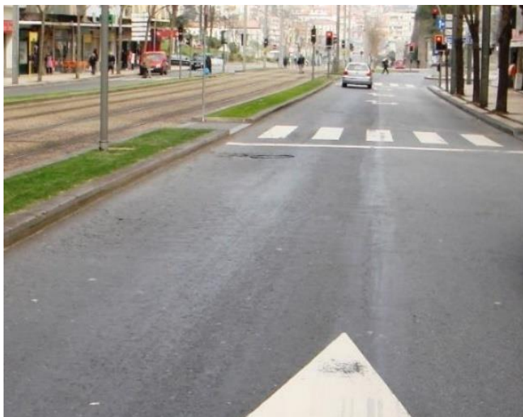
Figura 3.7 – Tipo de degradação: Rodeiras
