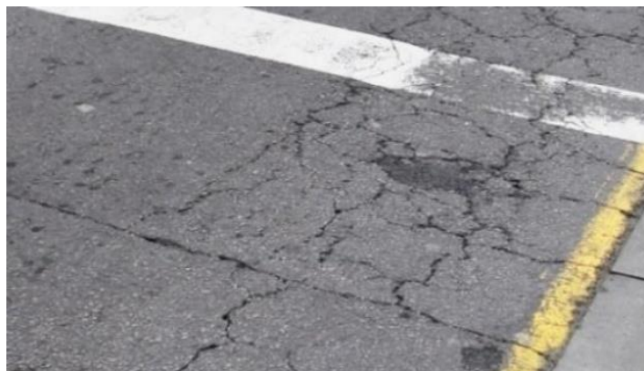
Figura 3.8 – Fendilhamento: Fendas transversais no pavimento
