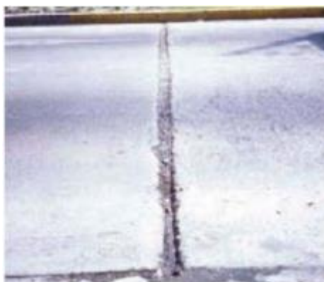
Figura 3.11 – Deficiência na selagem de junta [9]
