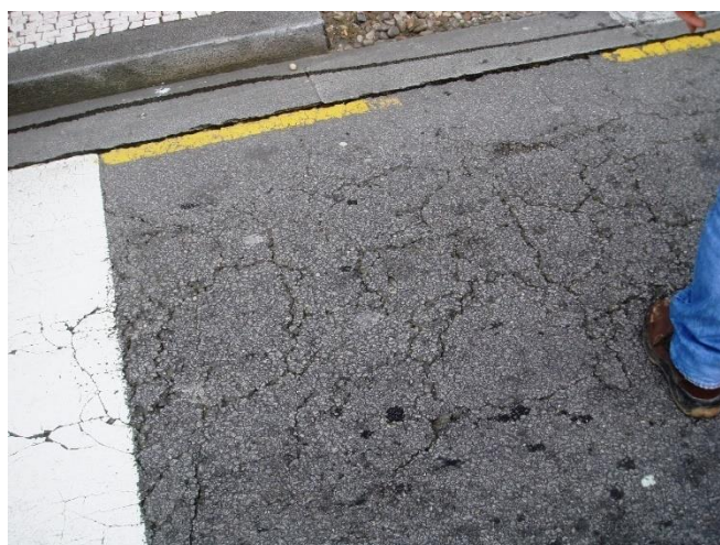
Figura 4.4 - Fendilhamento e deformação das guias de bordo
