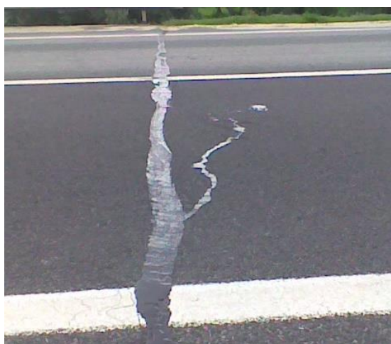
Figura 3.23 – Selagem de Fissuras (Inteval, 2016)
