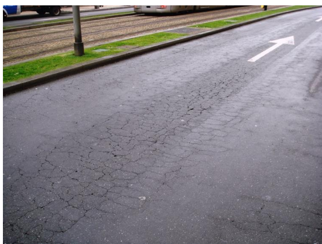
Figura 4.5 – Fendilhamento na zona das rodeiras
