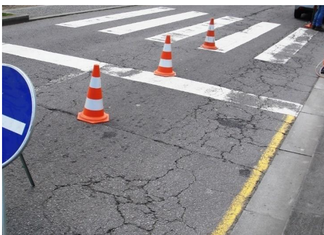
Figura 4.3 - Deformação localizada com pequenos abatimentos
