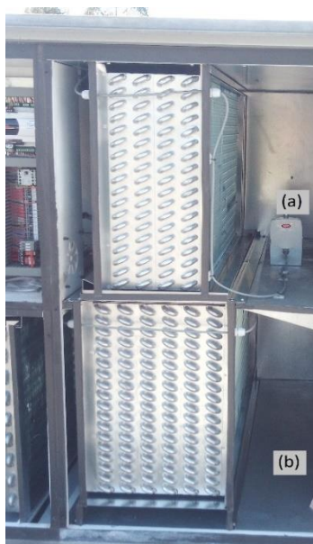
Figura 5- Baterias instaladas (a) extração (b) insuflação (registro fotográfico).
