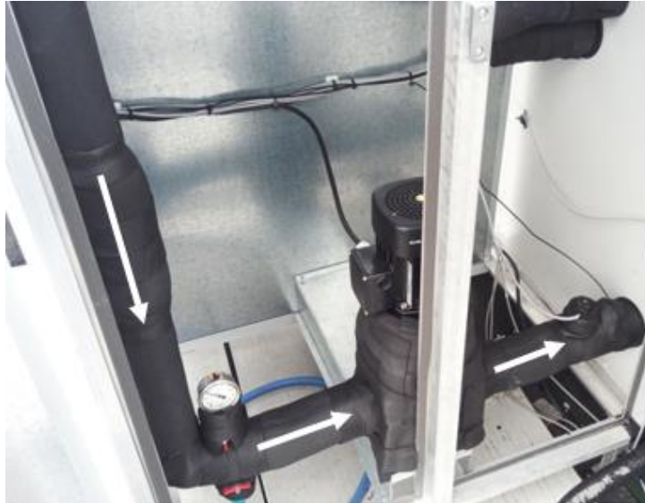
Figura 18- Isolamento (Armaflex) (registo fotográfico).
