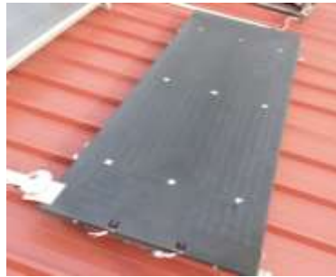
Figura 20 – Painel Solar Termodinâmico
