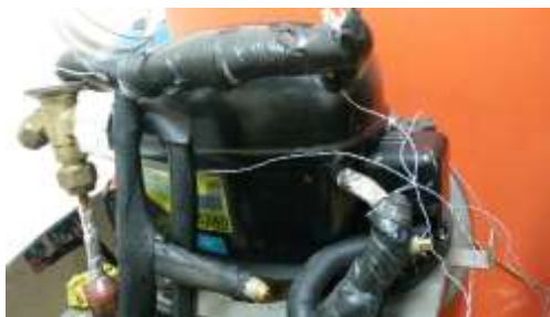
Figura 19 – Compressor da instalação
