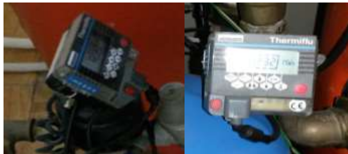
Figura 16 – Caudalímetro da instalação
