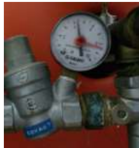
Figura 26 – Manómetro da instalação
