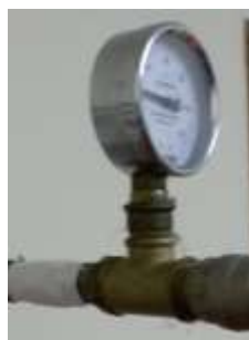
Figura 27 – Termómetro da instalação
