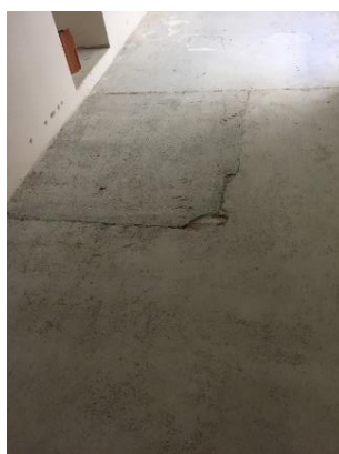
b) Fissuras ou buracos existentes
