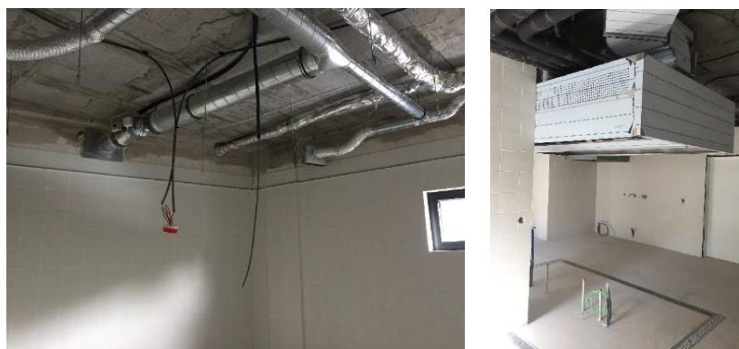
a) Sistema de ventilação/renovação de ar b) Sistema de extração de fumos
