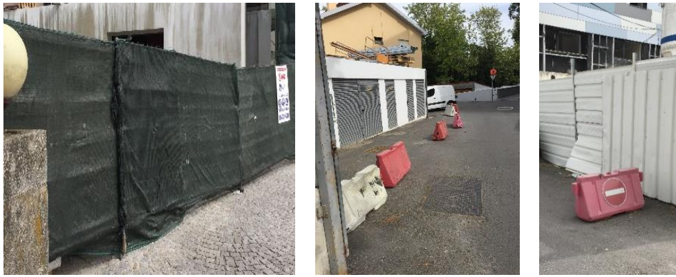
a) Rede de vedação
