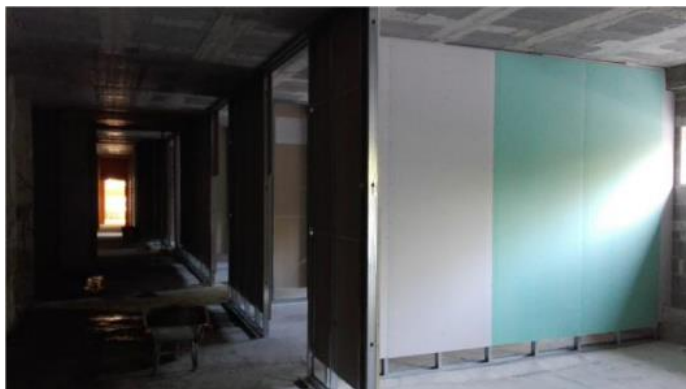
Figura 3.11 – Paredes em gesso cartonado
