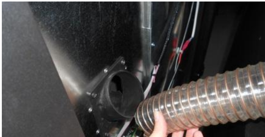
Figura 32 - Tubo de ligação entre o alimentador e a CC | Fonte: [19]
