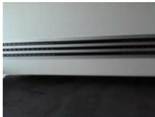
Figura 15 Pormenor do difusor linear de insuflação de ar limpo no auditório I 301
