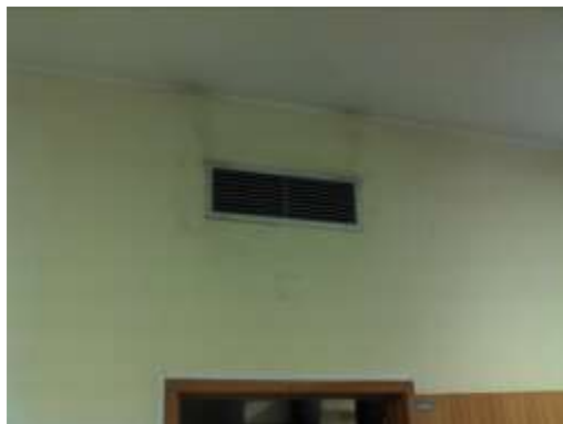
Figura 23 – Grelha de extracção de ar, suja na divisão dos sistemas informáticos E 307
