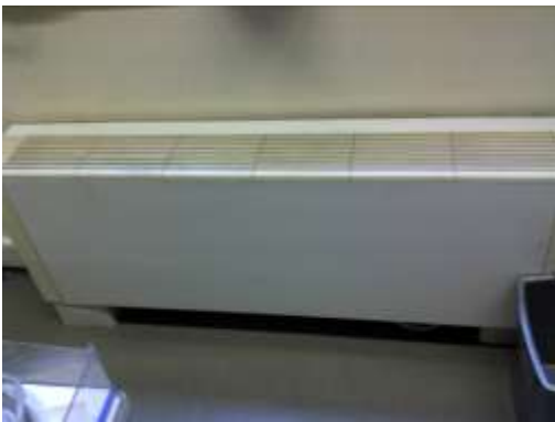
Figura 19 – Ventiloconvector da Biblioteca E 318 com alguma sujidade superficial
