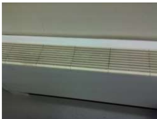
Figura 25 – Ventiloconvector com sujidade superficial na divisão dos sistemas informáticos E 307
