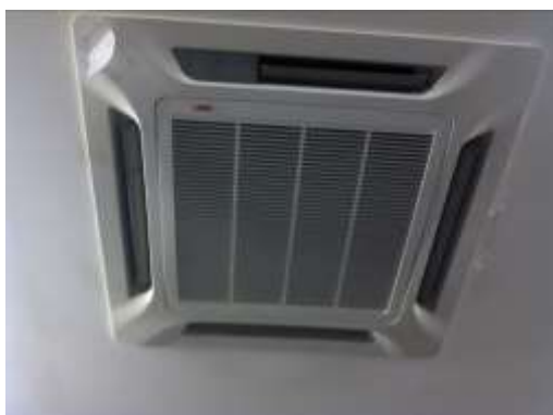
Figura 17 – Split de cassete do lado direito da biblioteca E 127
