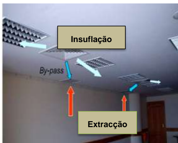
Figura 9 Insuflação e extracção muito próximas; eficiência de 60%
