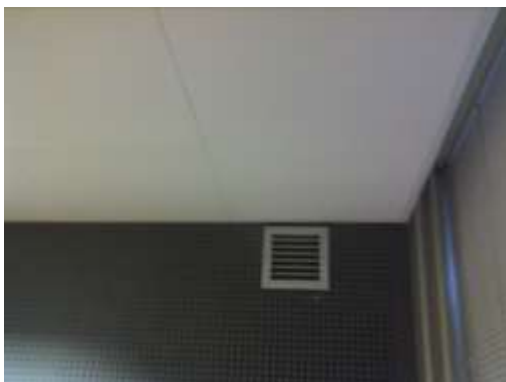
Figura 16 Grelha de extracção de ar ao fundo do auditório I 301
