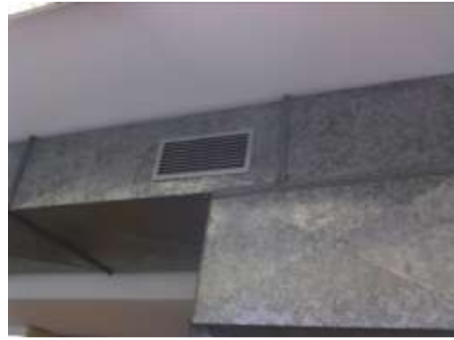
Figura 22 – Sistema de aquecimento existente na biblioteca E 323 que anteriormente funcionava no Inverno (sistema implementado para apenas aquecer)
