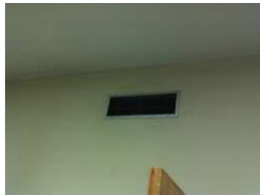
Figura 24 – Grelha de insuflação de ar limpa na divisão dos sistemas informáticos E 307
