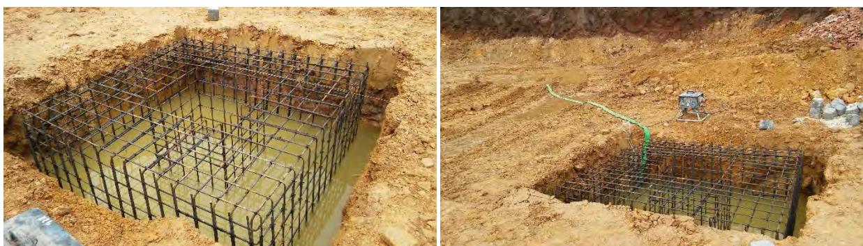
a) Problemas de drenagem das sapatas.
