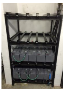
Figura 11 - Armário de Baterias (Bainga, n.d.)
