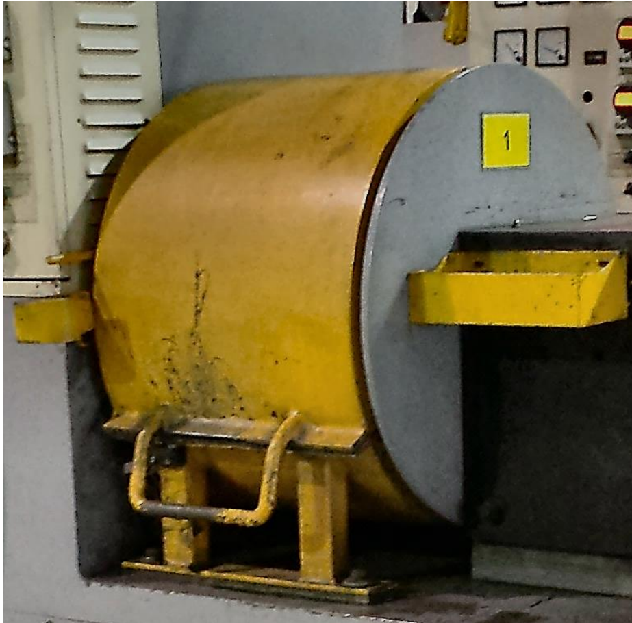
Figura 250 – Tambor e respetiva tampa de isolamento dos órgãos mecânicos que se encontram no seu interior.
