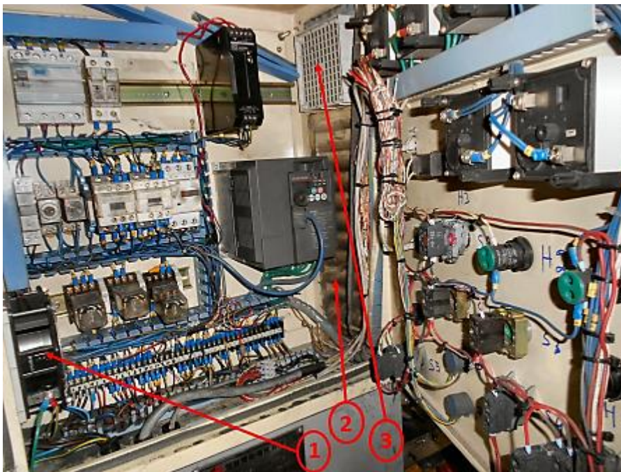
Figura 241 – Interior de um quadro elétrico: 1- Ventilador; 2- Alhetas de saída de ar (entrada de pó); 3- Extrator.
