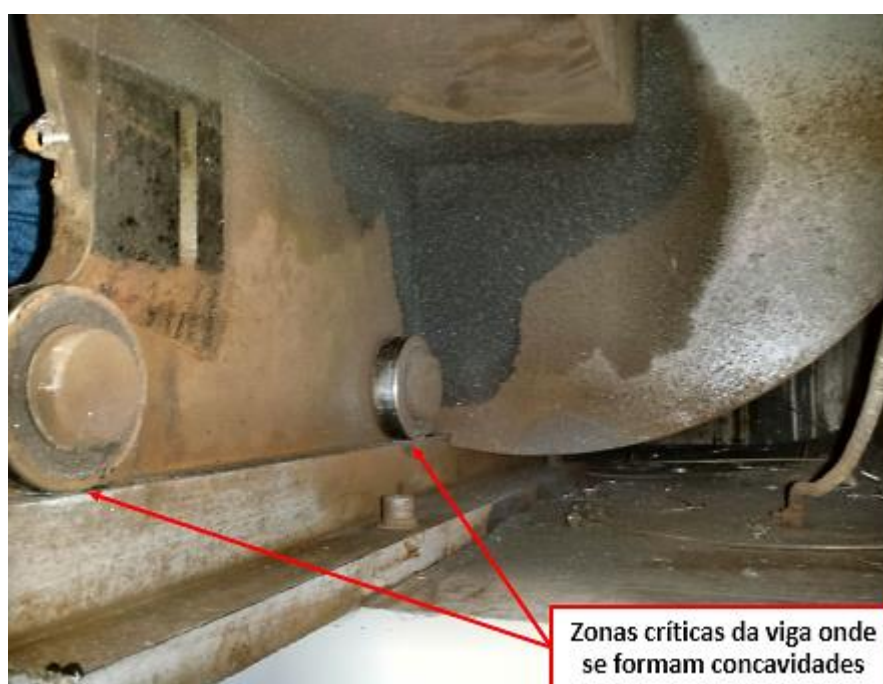
Figura 257 – Zonas críticas da viga que sustenta o carro deslizante (tensor mecânico tinha sido retirado para reparação).
