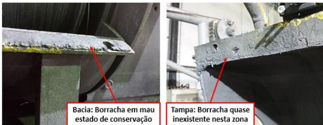
Figura 254 – Bacia e tampa do tambor com borrachas em mau estado de conservação.
