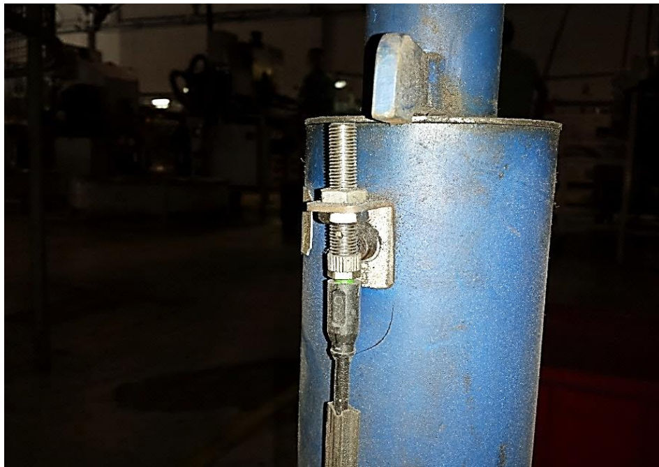
Figura 117 – Sensor de detecção de movimento da parábola.
