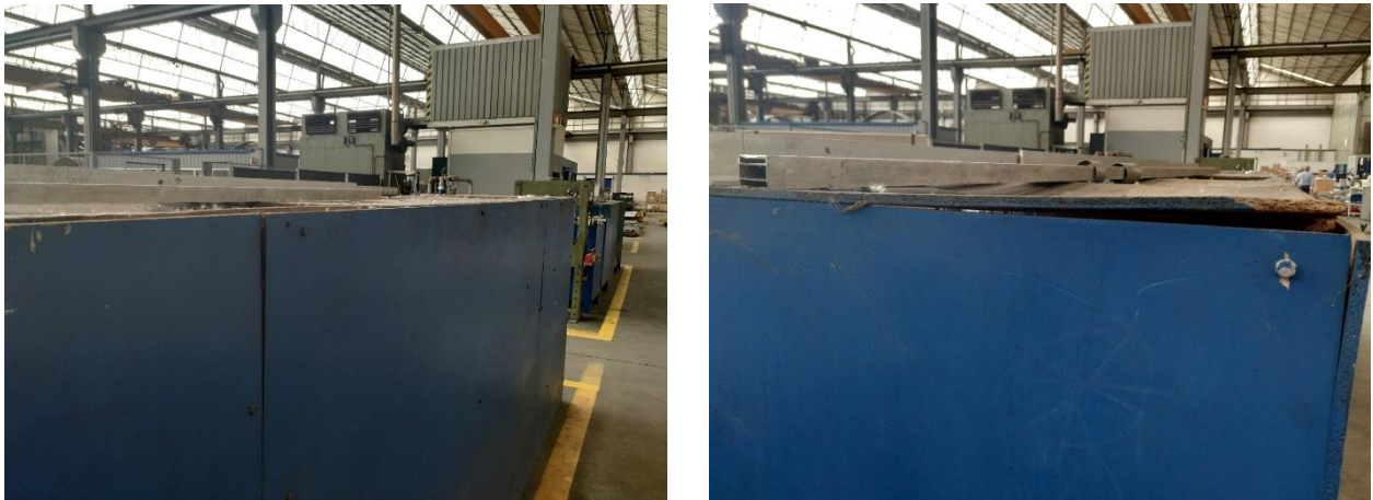
Figura 27 – Degradação do armário de armazenamento de materiais.
