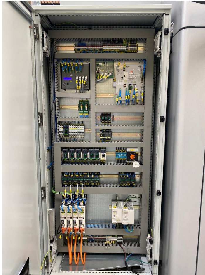
Figura 32 - Exemplo de quadro elétrico de uma máquina
