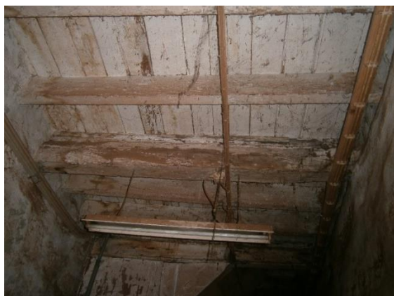
a) Face inferior do pavimento
