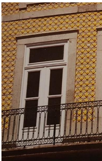
Figura 4.7 – Vão envidraçado de caixilharia de madeira sem proteção e vidro simples [6]
