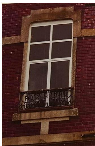
Figura 4.10 – Vão envidraçado de caixilharia metálica sem proteção e vidro simples [6]
