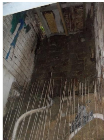
b) Fase de construção da parede de suporte do morro nos pisos superiores
