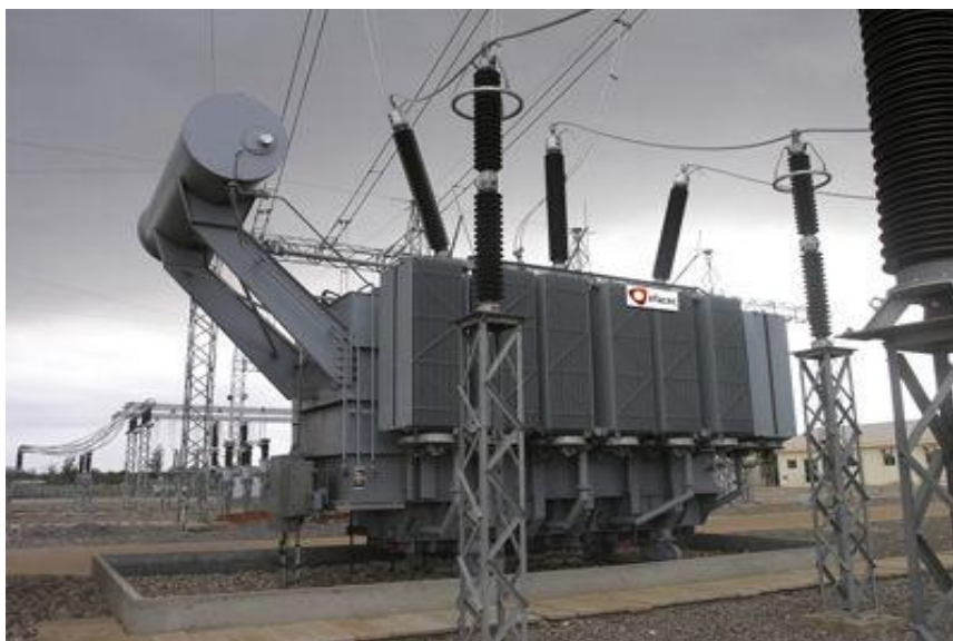
Figura 1.5 - Transformador de potência
