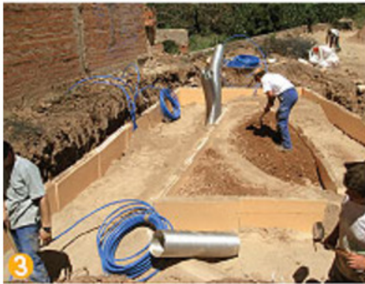
3- Tubos de ventilação concêntricos (aço inoxidável).
