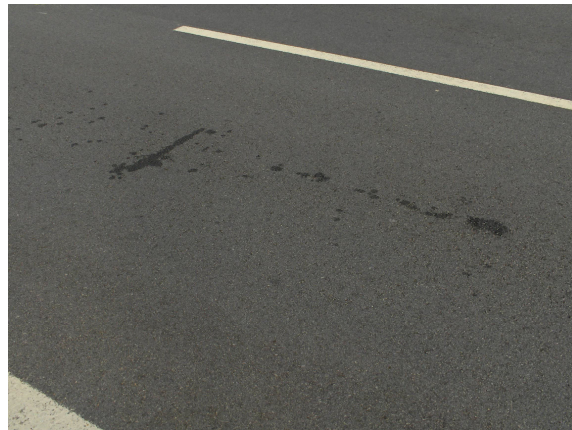
Figura 83 – Pormenor de um derrame
