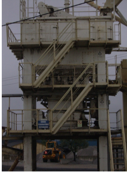
Figura 53 – Unidade de mistura (reservatório de agregados a quente+ criva + misturador)
