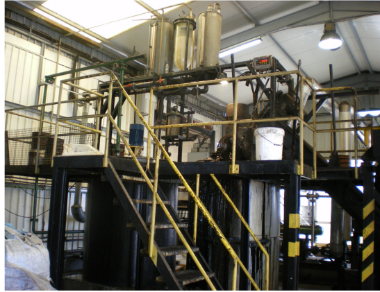
Figura 6 – Aspecto geral da instalação para a modificação do betume
