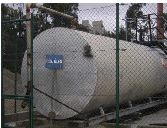
Figura 48 – Tanque de fuelóleo
