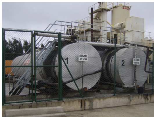
Figura 51 – Tanques de armazenamento de betume
