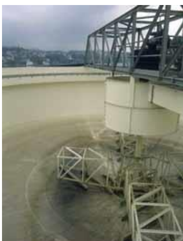
Figura 16 - Unidade de tratamento de lamas
