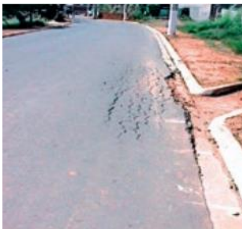
Figura 20: Afundamento por consolidação localizado (ALC) (Bernucci et al., 2008)
