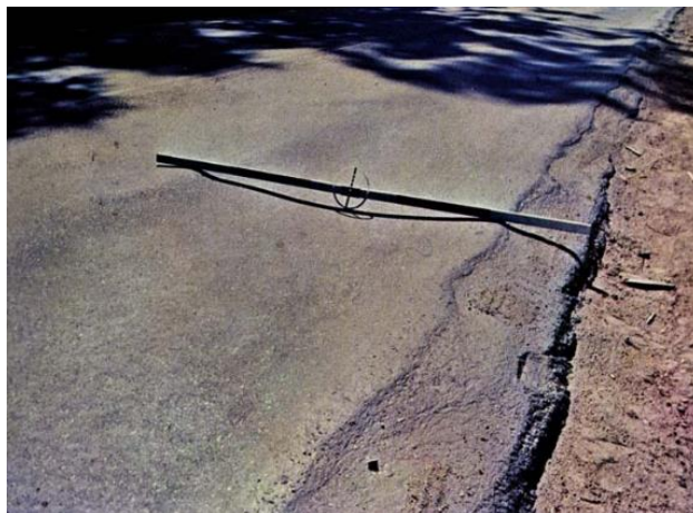
Figura 18: Afundamento de trilha de roda (DAER-RS, 1978 Apud. DNIT, 2003a)
