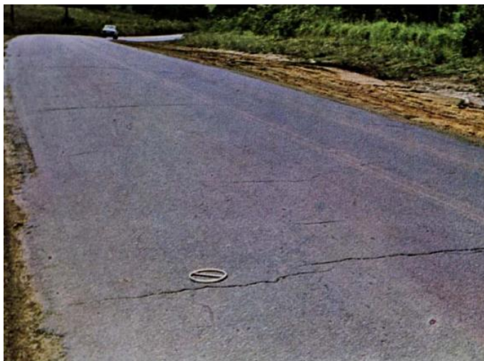
Figura 11: Trinca isolada transversal (DAER-RS, 1978 Apud. DNIT, 2003a)
