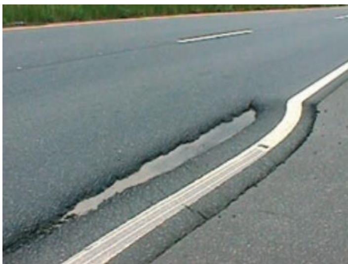
Figura 23: Escorregamento de revestimento (Bernucci et al., 2008)
