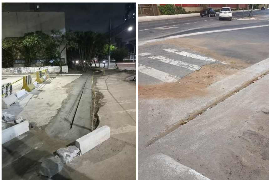
Figura 50: Valeta reconstruída e via danificada devido a intervenção
