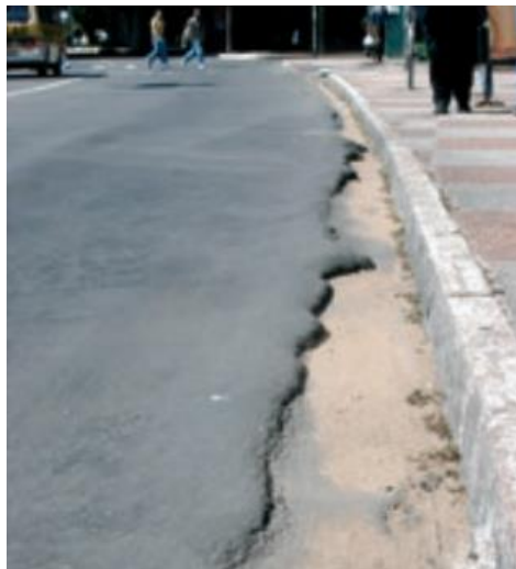
Figura 22: Escorregamento de massa (Bernucci et al., 2008)
