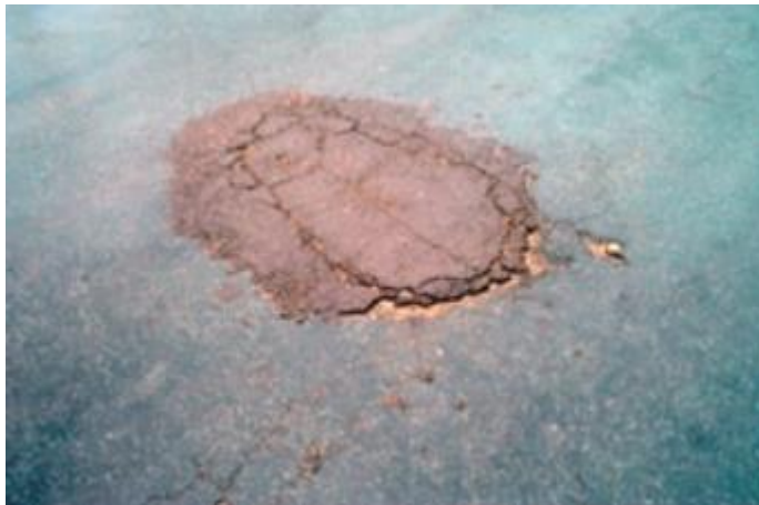
Figura 28: Remendo mal executado (Bernucci et al., 2008)
