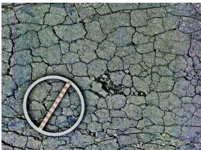
Figura 15: Trinca interligada tipo jacaré (DAER-RS 1978 Apud. DNIT, 2003a)
