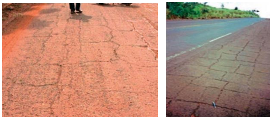
Figura 16 (à esquerda): Trincas de bloco com erosão (Bernucci et al., 2008)
