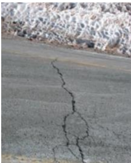
Figura 12: Trinca de retração térmica (Bernucci et al., 2008)
