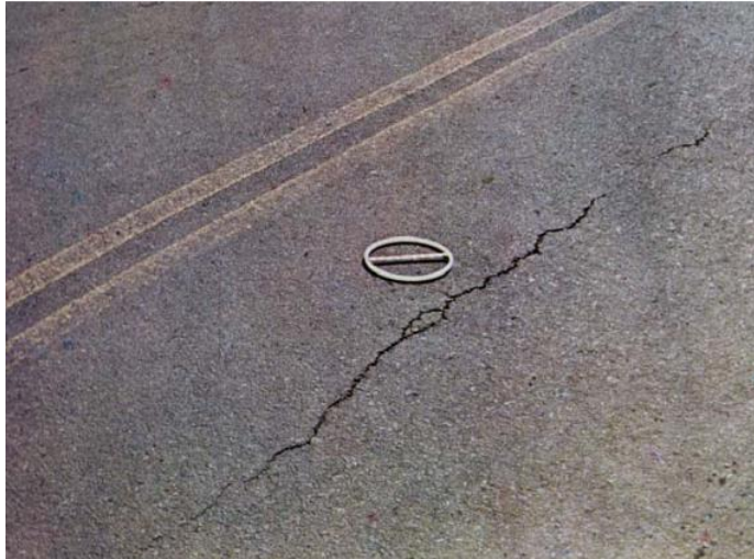
Figura 13:Trinca isolada longitudinal (DAER - RS, 1978 Apud. DNIT, 2003a)
