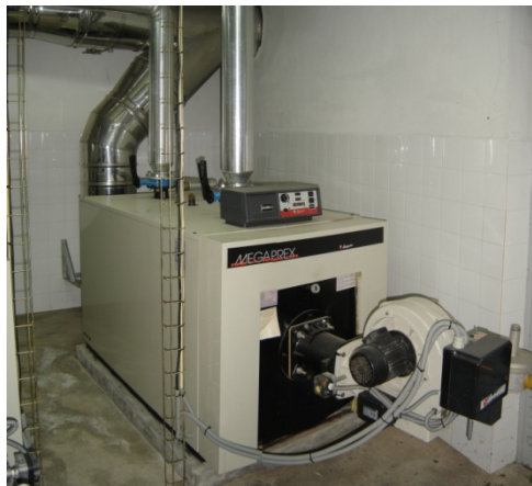
Figura 11 – Gerador de calor
