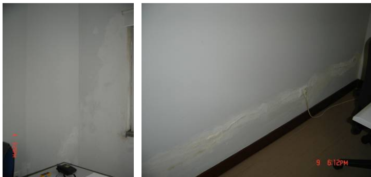
Figura 34 – Paredes dos gabinetes com evidências de infiltrações
