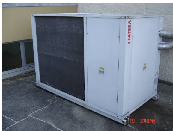
Figura 10 – Grupo de produção de água gelada – Chiller GAA
