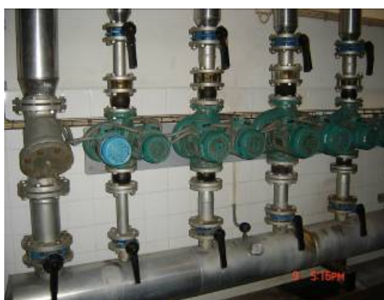
Figura 37 – Componentes da rede hidráulica sem isolamento térmico
