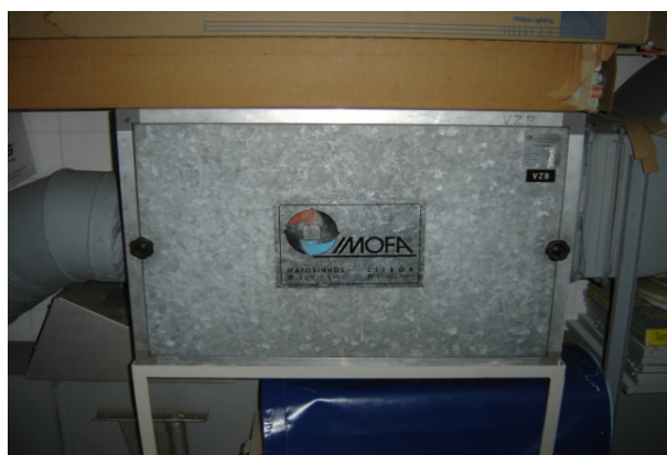
Figura 15 – Ventilador de extracção (VZB)
