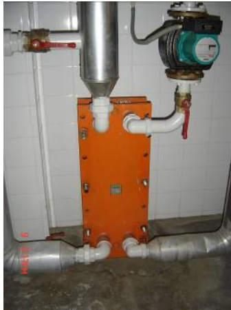
Figura 38 – Permutador de placas sem isolamento térmico
