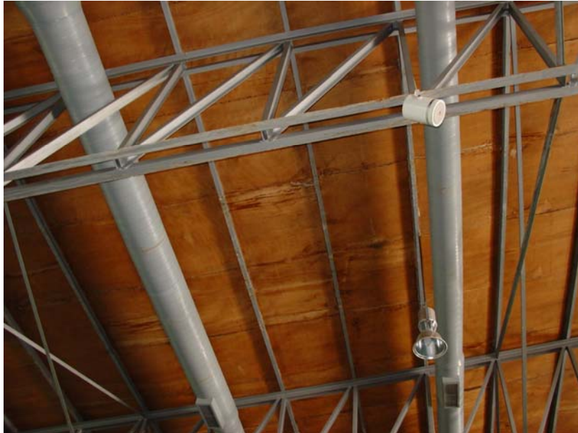
Figura 36 – Cobertura com evidências de degradação
