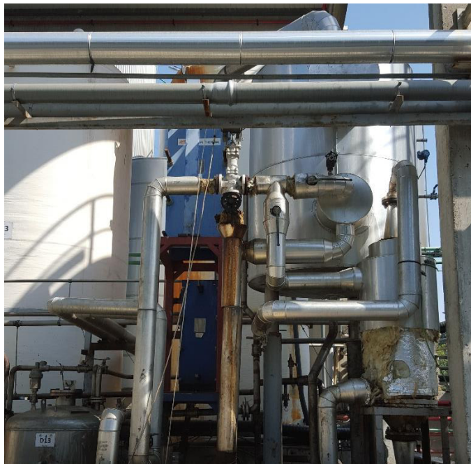
Figura 4. 40 - Fotografia da instalação do evaporador
