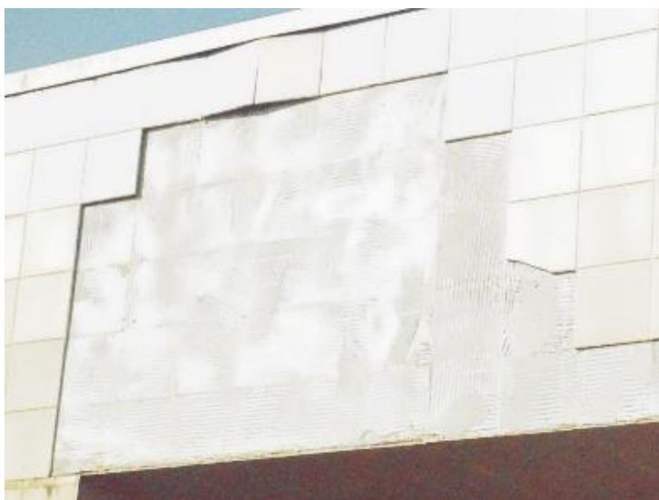
Figura 4.6 – Queda de material cerâmico no edifício principal do CICCOPN
