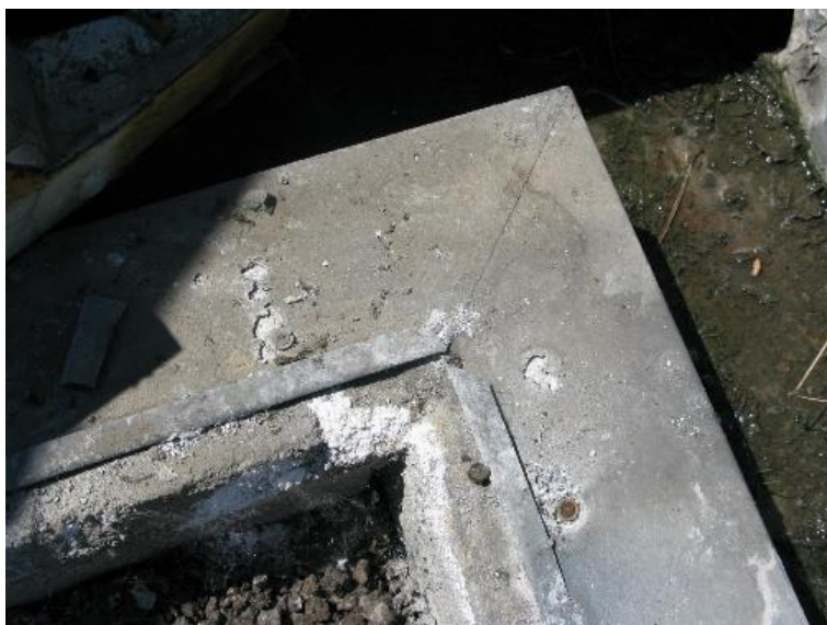
Figura 4.32 – Perfuração que se observa em algumas zonas na chapa de zinco
