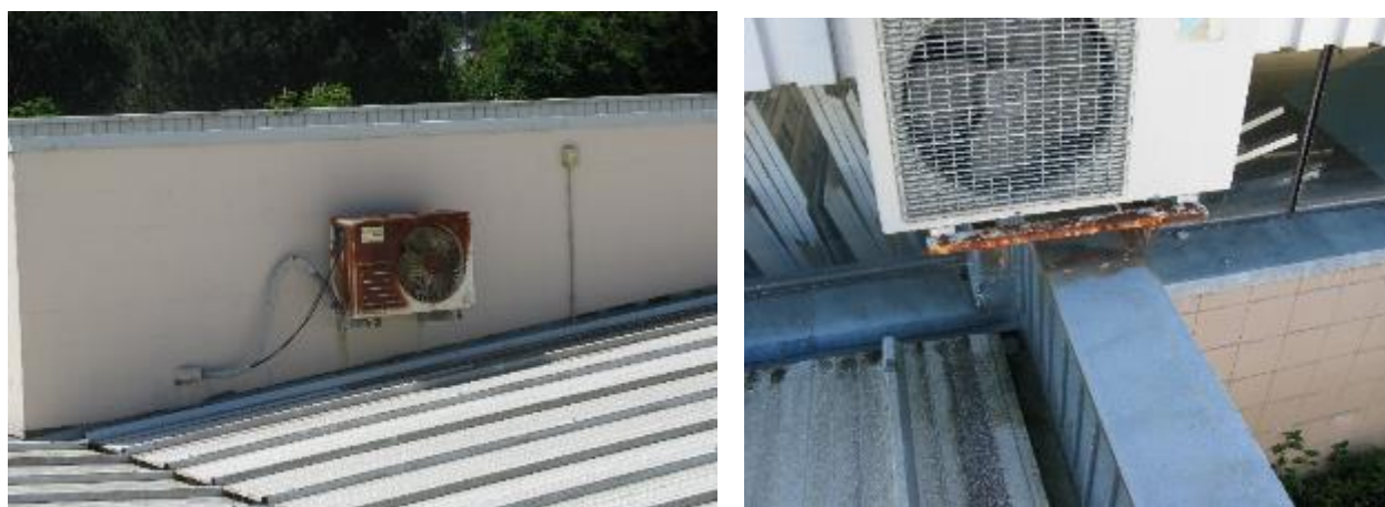
Figura 4.15 – Oxidação do suporte e sistema de AVAC
