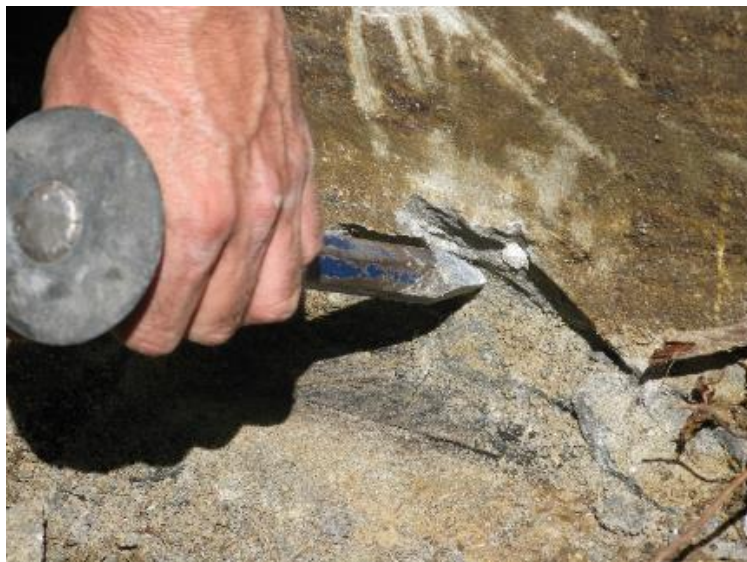
Figura 4.39 – Picagem da parede tendo-se constatado a inexistência de um sistema de impermeabilização
