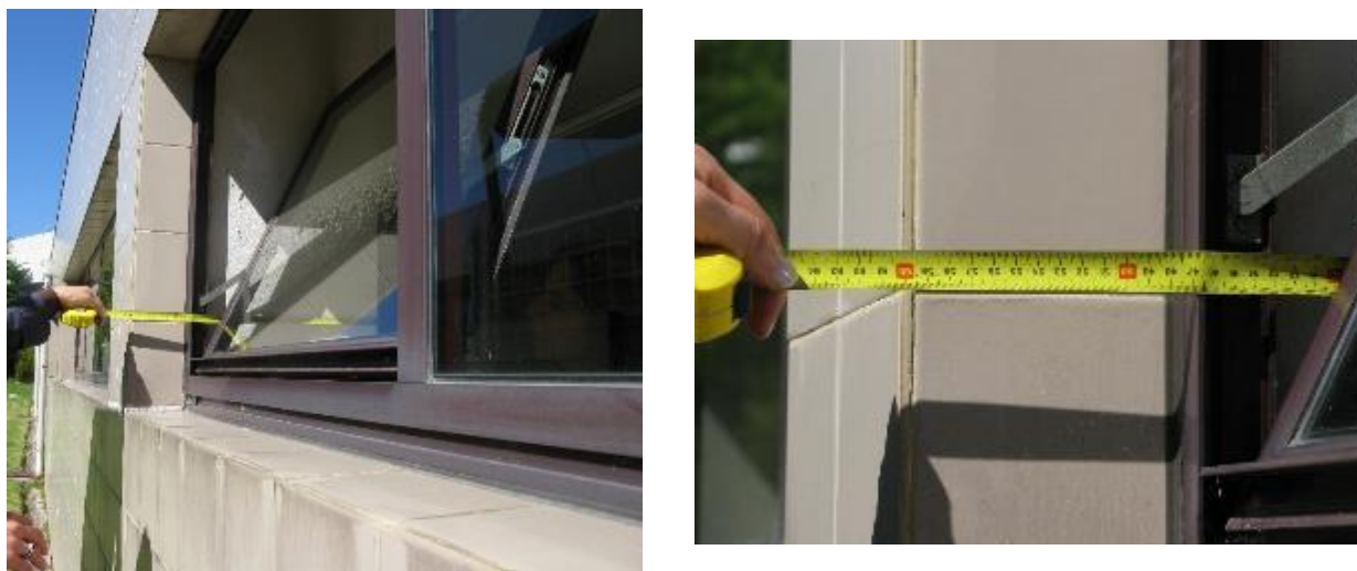
Figura 4.35 – Aspeto da parede Exterior
