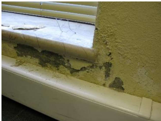
Figura 4.16 – Degradação do revestimento
