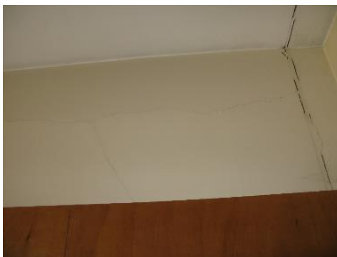
Figura 4.18 – Fissuração na zona da junta de dilatação
