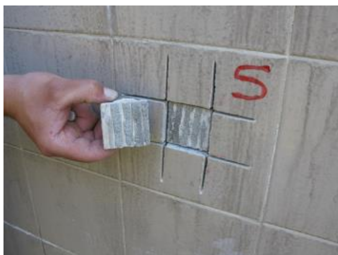
Figura 4.48 - Ensaio de arrancamento Ref.ª 5
