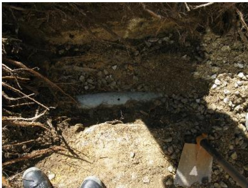
Figura 4.38 – Sistema de drenagem existente
