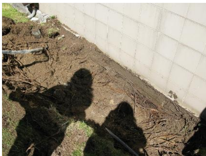
Figura 4.36 – Raízes existentes junto ao edificado
