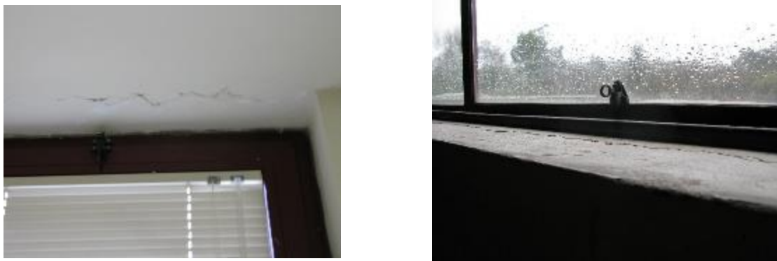
Figura 4.19 – Fissuração junto dos vãos envidraçados
