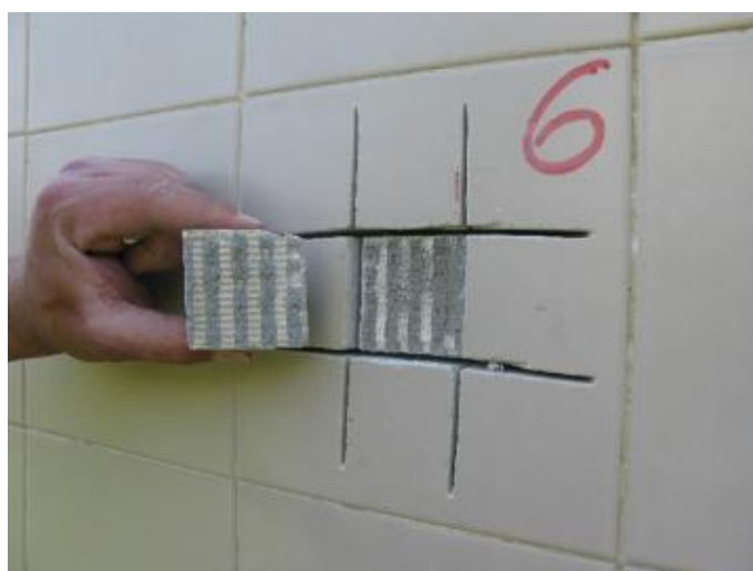
Figura 4.49 - Ensaio de arrancamento Ref.ª 6
