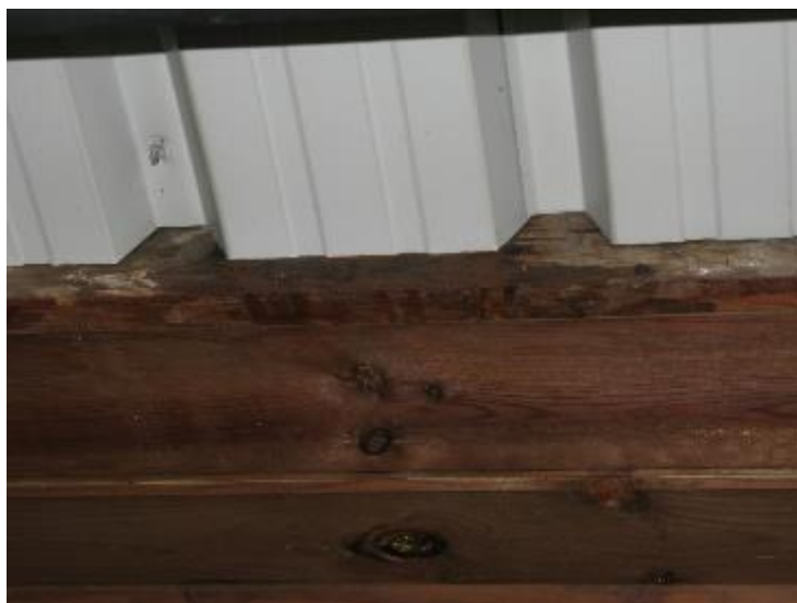
Figura 4.17 – Presença de água no revestimento de madeira da cobertura
