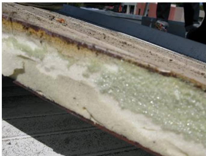
Figura 4.33 – Oxidação das chapas na zona de corte e em contacto com o meio ambiente
