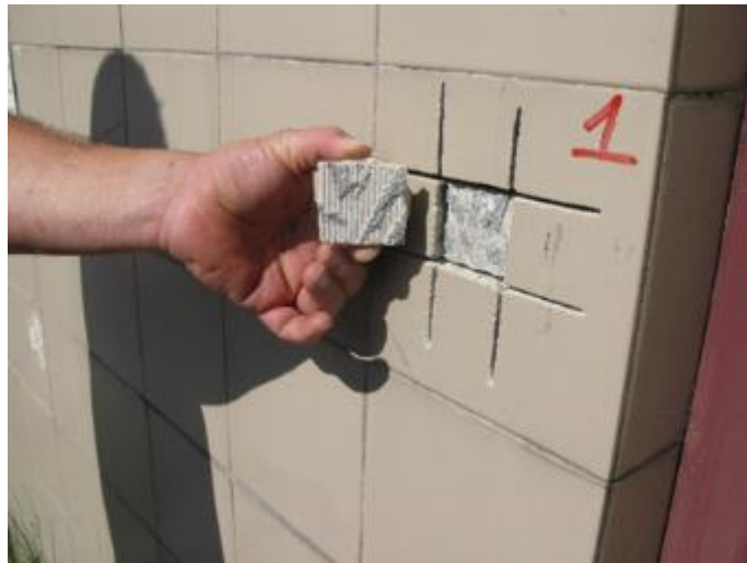
Figura 4.44 – Ensaio de arrancamento Ref.ª 1
