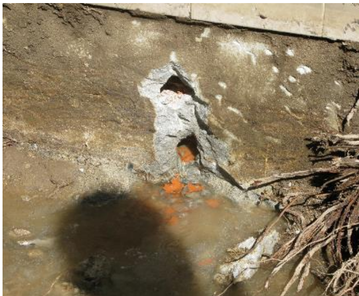
Figura 4.41 – “Fonte de água” na parede
