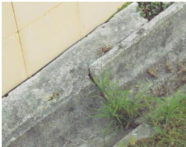
Figura 4.11 – Desnível na zona de união das valetas
