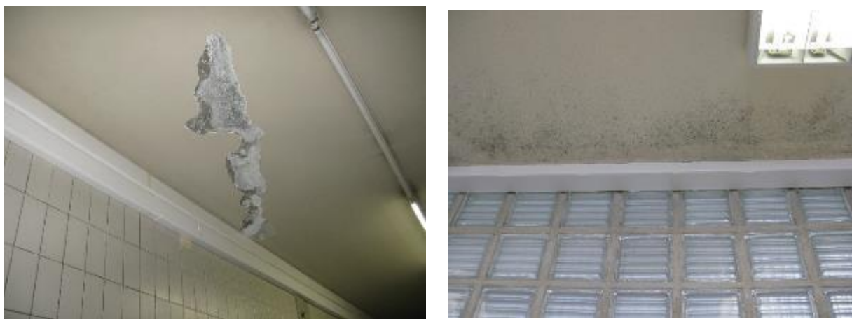
Figura 4.20 – Destacamento e presença de fungos no teto
