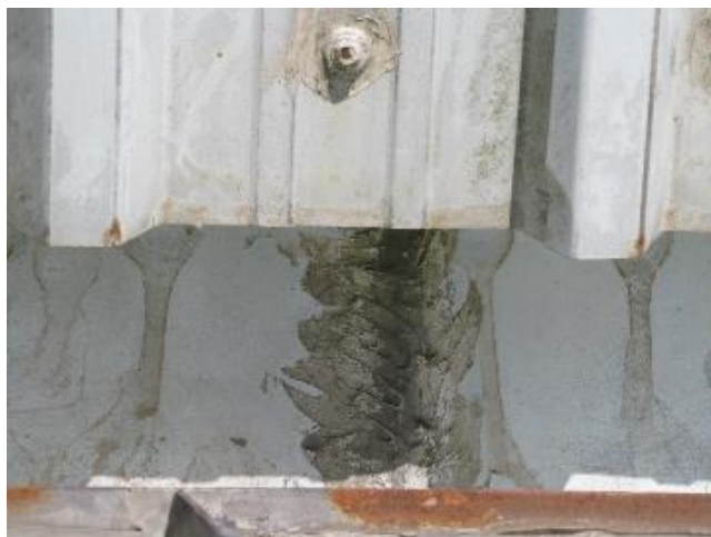
Figura 4.13 - Junta de dilatação existente nas caleiras de capa termo lacada
