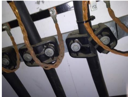
Figura 34 - Caixa de fim de cabo danificada
