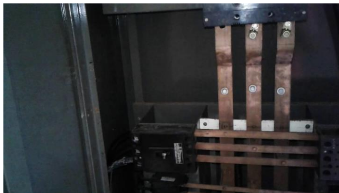
Figura 35 - Barramento de média tensão
