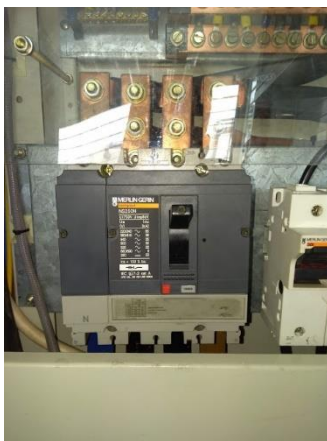
Figura 29 - Interruptor de Corte Geral de um Quadro Geral de Baixa Tensão
