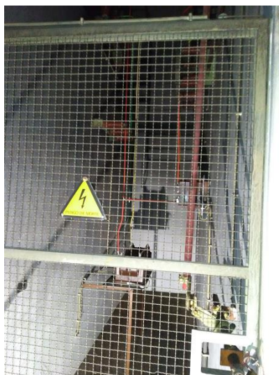
Figura 31 - Seccionador de Média Tensão
