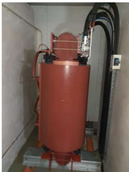
Figura 5 –Transformador do posto de transformação de cliente do Museu
