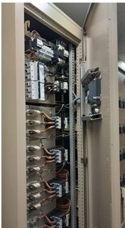
Figura 10 – Vista geral da bateria de condensadores instalada no posto de transformação do Museu
