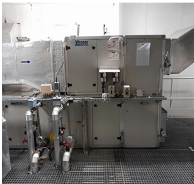
Figura 17 – Unidade de Tratamento de Ar das salas 6 e 7 do Museu
