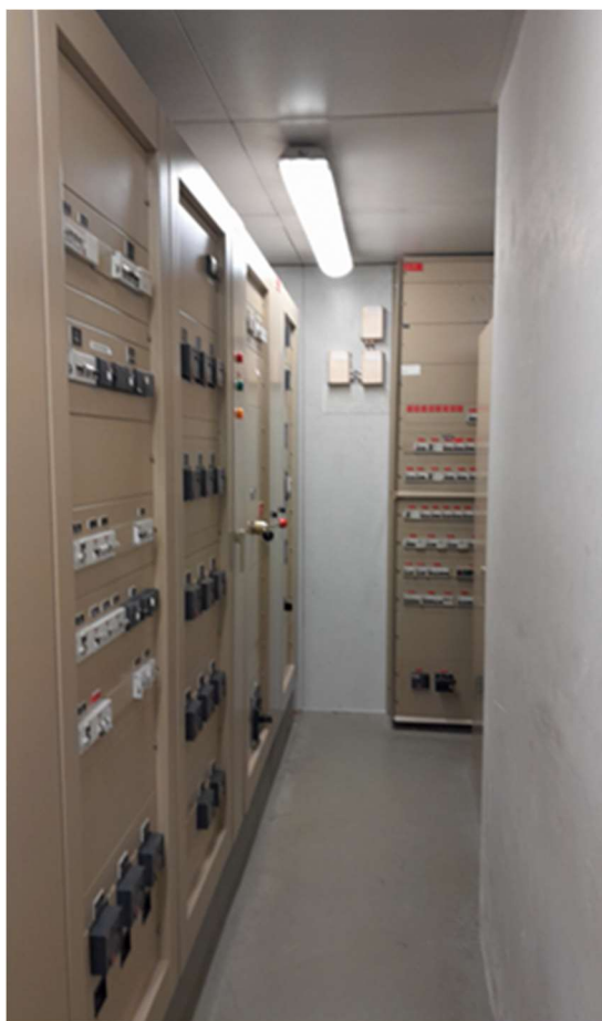
Figura 8 – Vista geral do quadro geral no posto de transformação de cliente
