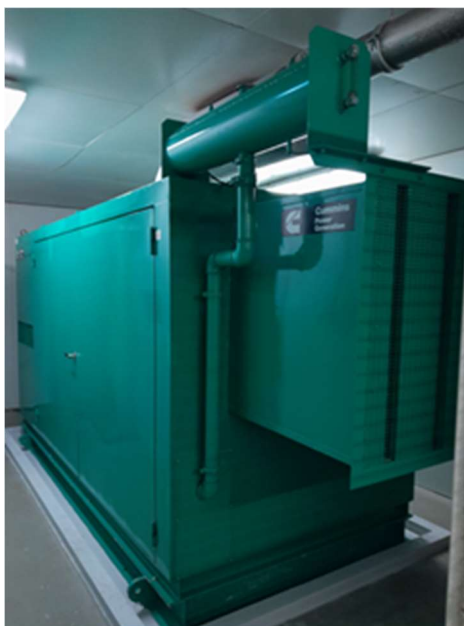
Figura 6 – Vista geral da sala do grupo gerador
