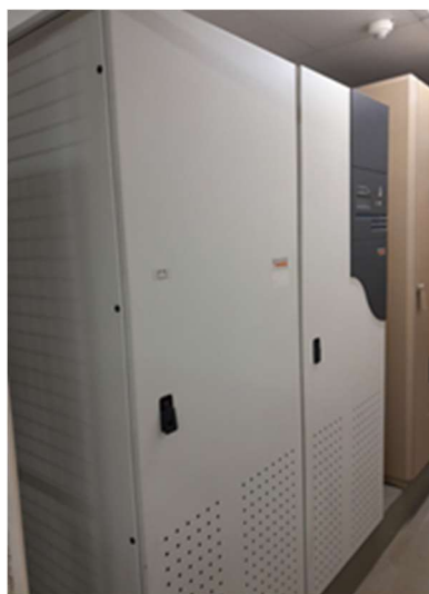
Figura 7 – Vista geral da unidade de alimentação ininterrupta (UPS) do Museu
