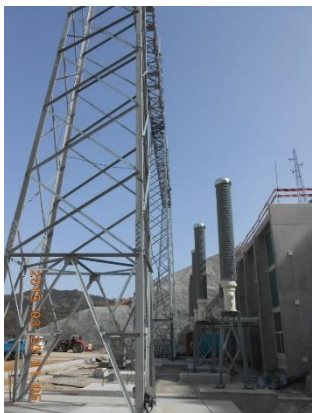
Figura 14: Pórtico de amarração da linha de 400kV
