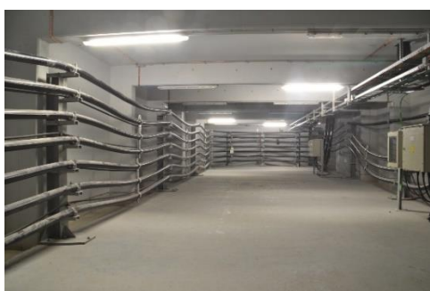
Figura 11: Cabo de 400kV instalado na base do edifício de comando 400kV
